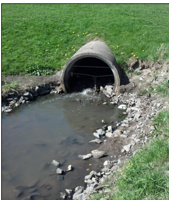
Figur 3. Dagvattenledning med dimensionen 1200 mm, med utlopp uppströms dagvattendammarna
