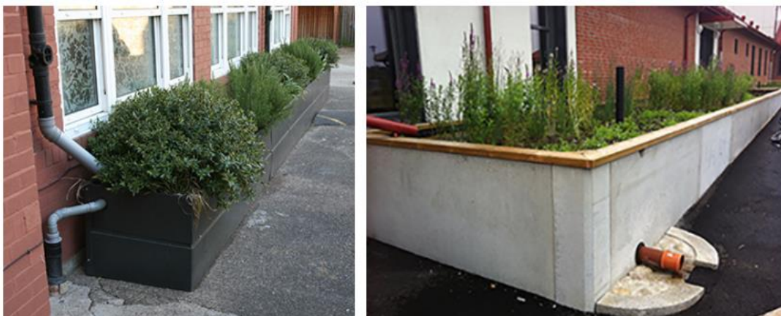
Figur 11. Biofilter i upphöjd planteringslåda. (Bildkälla: rent-dagvatten.se)
