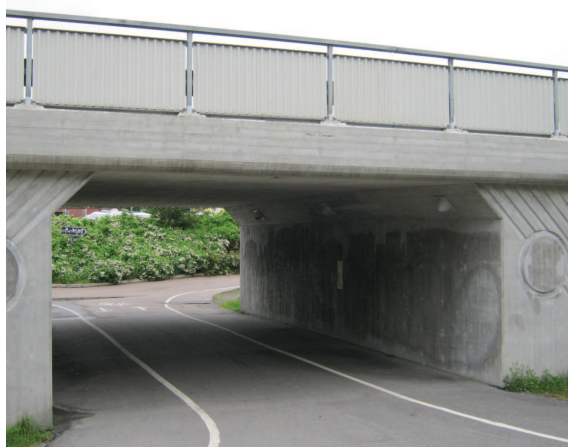
Gångtunnel under väg 155 med dålig sikt.
