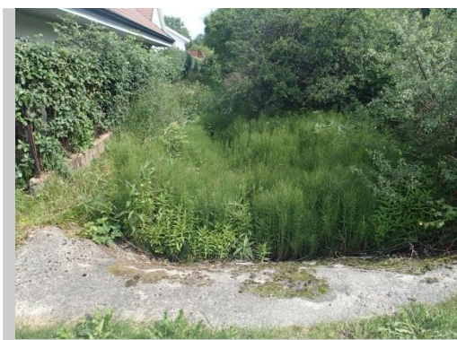
Foto 1: Kulvertering övergår till öppet dike.
