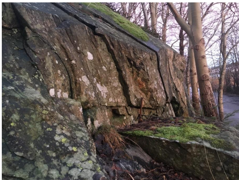
Foto 3. Berget är uppsprucket i större block med vida och djupa sprickor.
