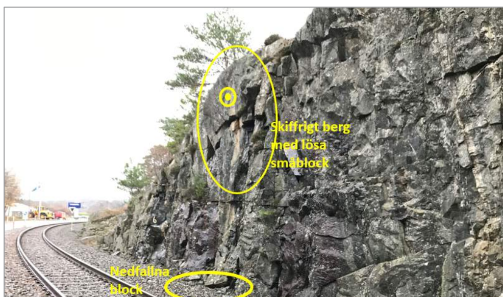
Figur 23. Ring markerar block som bör bultas fast. Området runt blocket bör bli föremål för skrotning så att löst material rensas bort.
