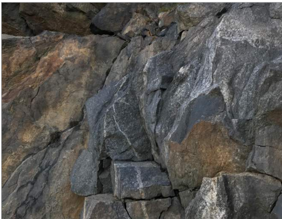
Figur 20. Röd-gula järnutfällningar på skärningen väster om TX-porten. Denna typ av missfärgningar kan indikera förekomst av sulfidförande berg.
