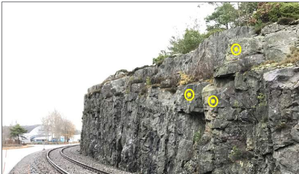
Figur 22. Ringar markerar block som bör bultas fast. Området runt blocket bör bli föremål för skrotning så att löst material rensas bort.
