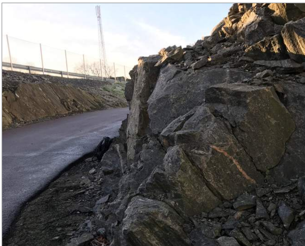
Figur 13. Exempel uppsprucket, sannolikt sprängskadat, berg vid krocktestanläggningen.
