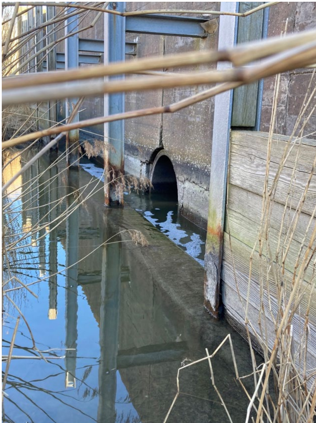
Figur 6. Det anlagda skibordet mellan Karholmsdammen och Södskärsbassängen gör att vattengenomströmning endast sker vid högre vattenstånd. Bilden är tagen från Karholmsdammens sida.
