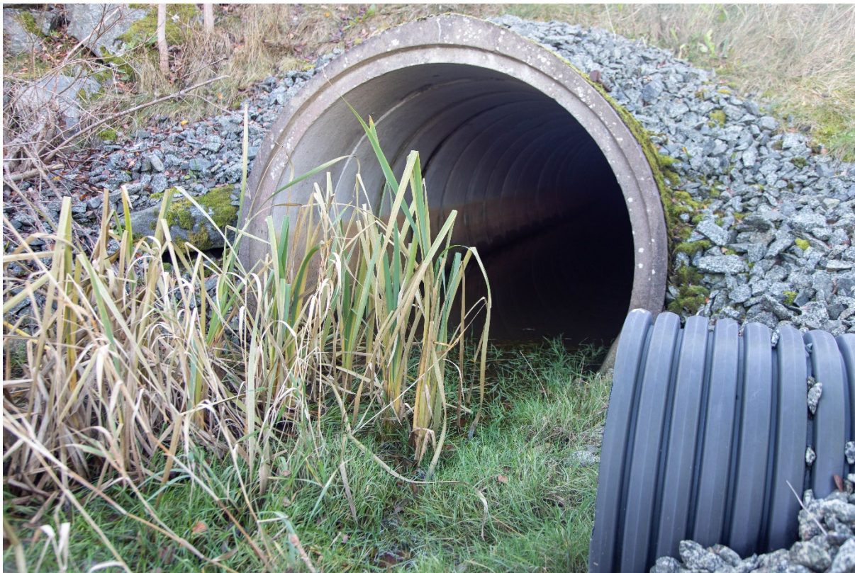
Figur 4 Trumma under vägbank norr om delområde A (dimension ca 2000 mm respektive ca 800 mm). Fotad från norr. Ingår i del av dagens markavvattningsföretag som är kulverterad. Vattnet leds mot bäckravinen. Ungefärlig lokalisering av var fotot är taget i redovisat i bilaga 2.
