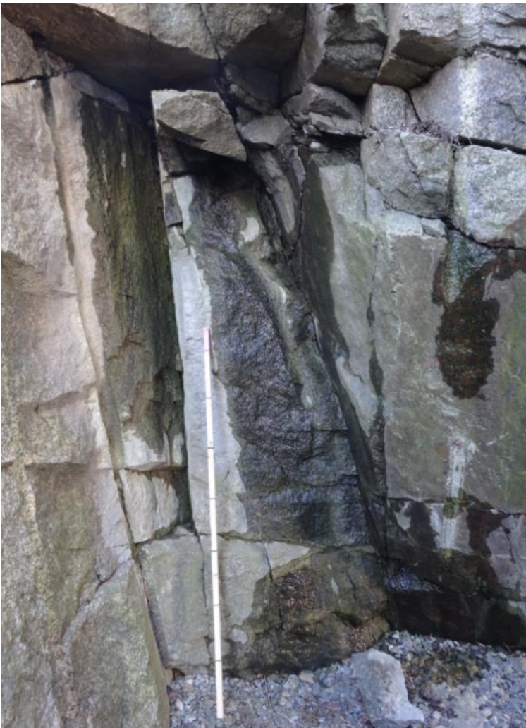
Bild 8 tagen mot söder i hörnet av byggnaden där fanns några lösa block som riskerar att ramla ner ovan mätpinnen som är 1,5 m hög. Avståndet är dock för stort för att det skall påverka byggnaden. På planskissen norra delen är området markerat 2:1 block.
