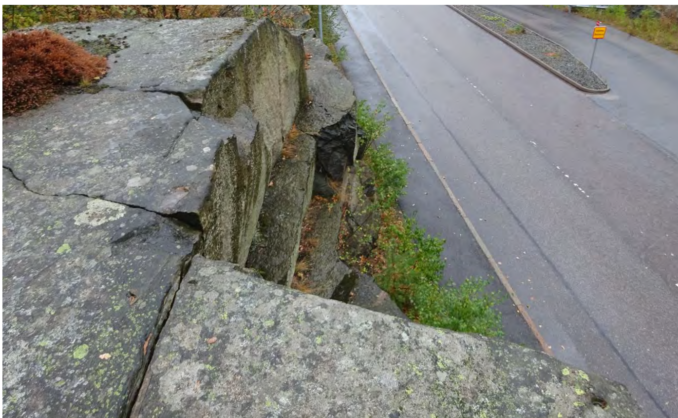
Bild 6 också taget på släntrön något längre bort och där ser man att vertikala sprickor format slänten efter sprängningen. Riktning ungefär mot sydväst.
