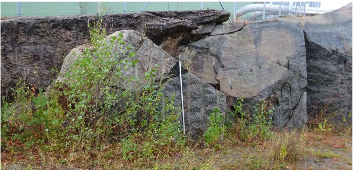
Bild 24 på en gjuten grovbetong som stack ut i luften direkt ovan skrotspett. Den delen kan tas men skulle den spricka så finns inga risker då den hamnar bakom stora blocket som finns bakom skrotspettet.
