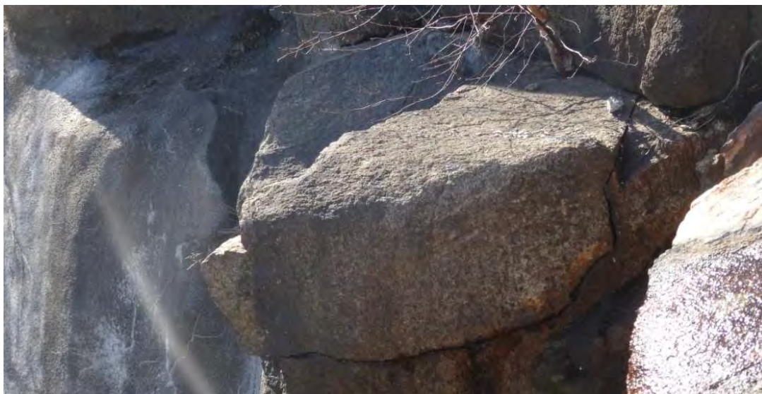
Bild 24 på blocket som omnämns vid bild 23. Förslagsvis görs skrotning i ett första steg för att se om det är rörligt.
