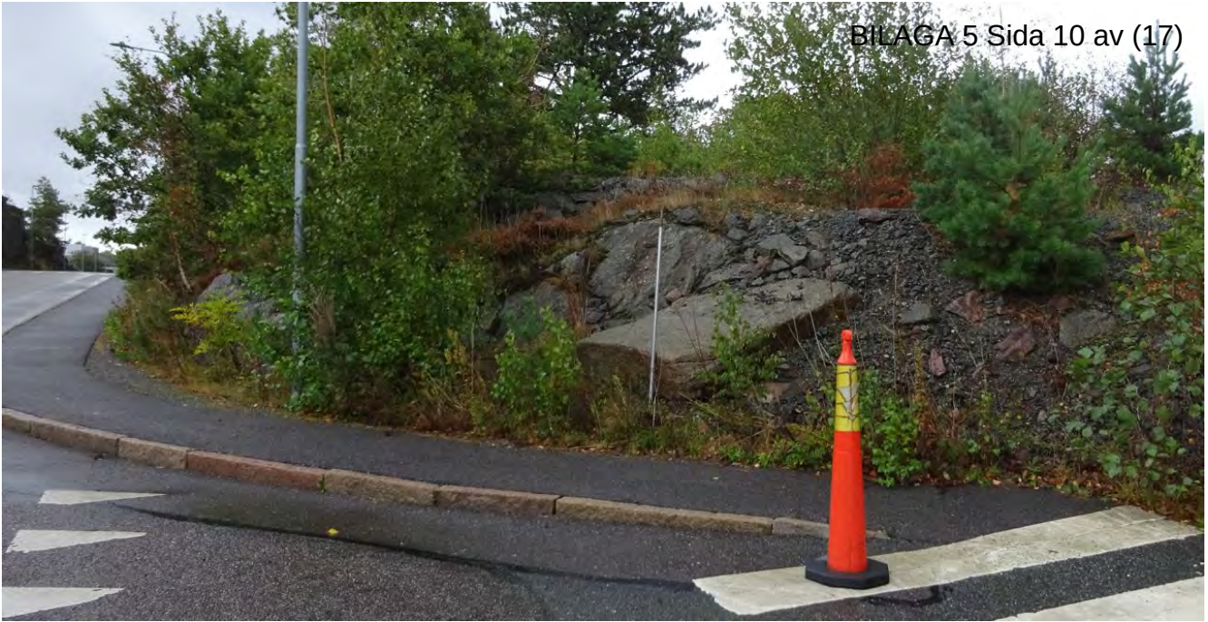
Bild 16 tagen på flackare berg vid infartsvägen längst i söder på område 2. Inga stabilitetsproblem.
