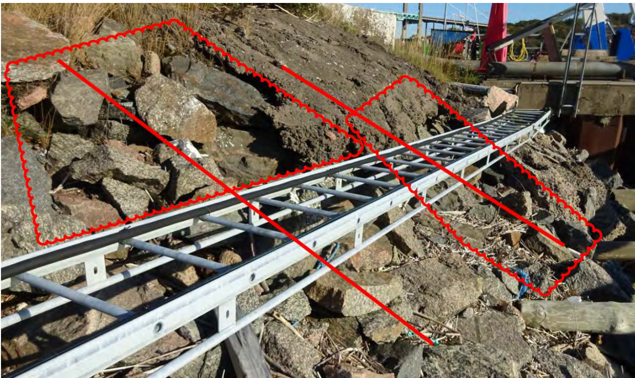
Bild 11 tagen på området längst i öster där åtgärd 2 föreslås då slänten lutar lite för mycket. Sannolikt krävs mer grovbetong då ledningen ligger i vägen så det blir svårt att lägga ut grovt krossmaterial med flackare lutning helst < 1:1.5 .
