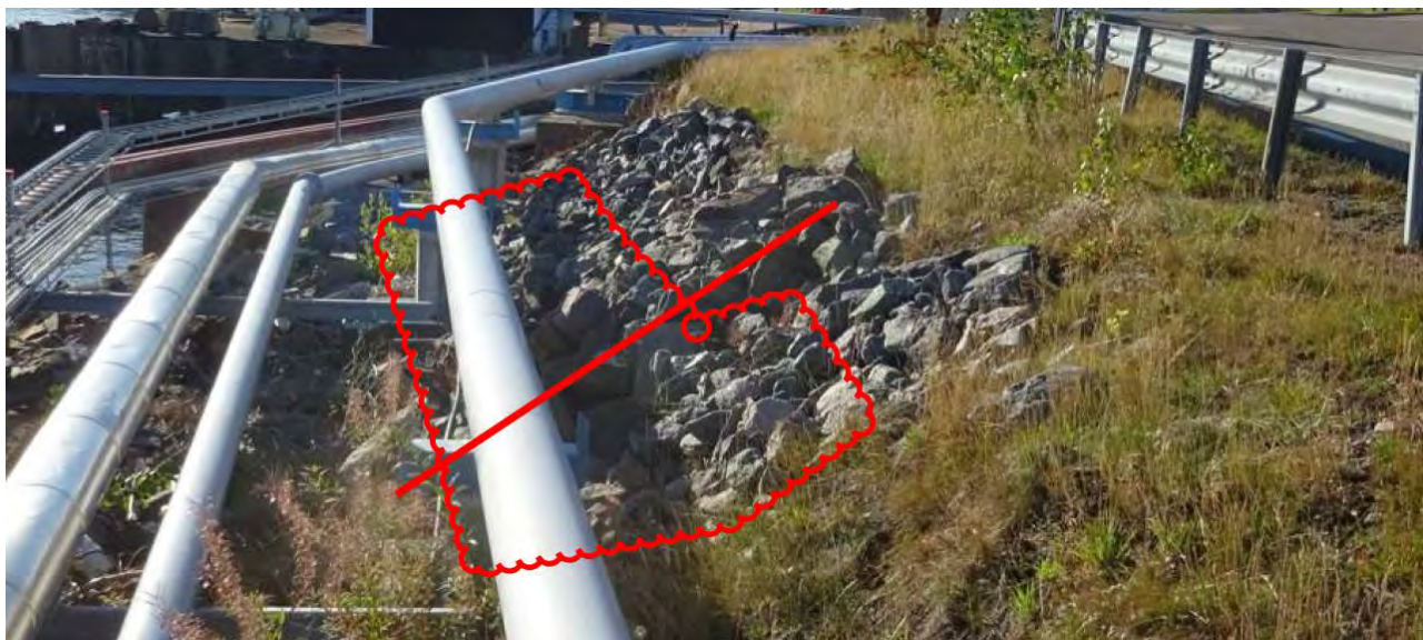
Bild 10 tagen på området där åtgärd 1 föreslås då slänten lutar lite för mycket. Enklast är att påföra krossmaterial för att göra lutningen flackare ( < 1:1.5 )
