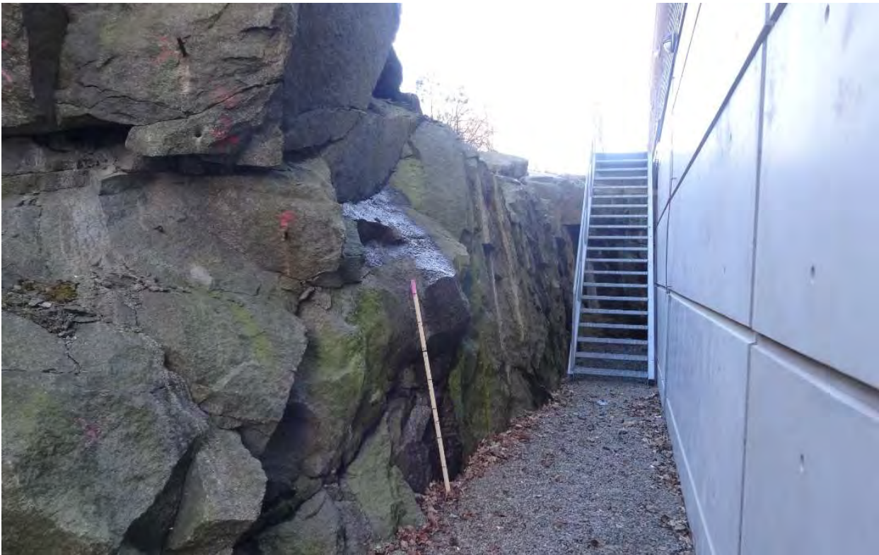
Bild 9 tagen mot söder där en bult bedöms saknas. Övriga block har säkrats med bultar.
