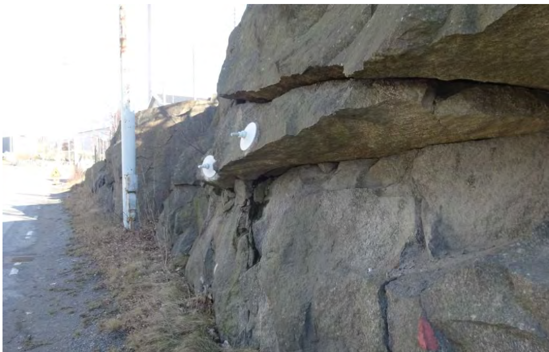
Bild 32 tagen mot öster längs med vägen där man kan se något högre skärning längre västerut där block har förankrats med bultar då överhäng har skapats. Inga stabilitetsproblem föreligger då förstärkning utförts.
