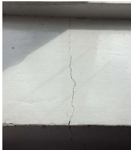
Figur 6 Spricka i centrerat fönster i östra delen av fasaden
