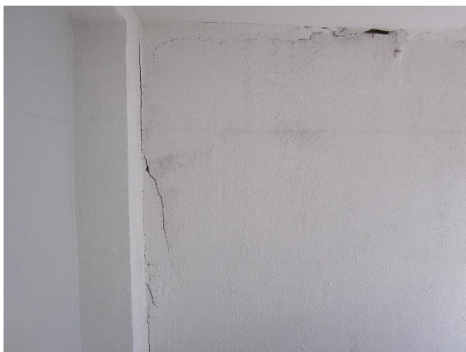
Figur 10 Sprickor i putsen Rum 405
