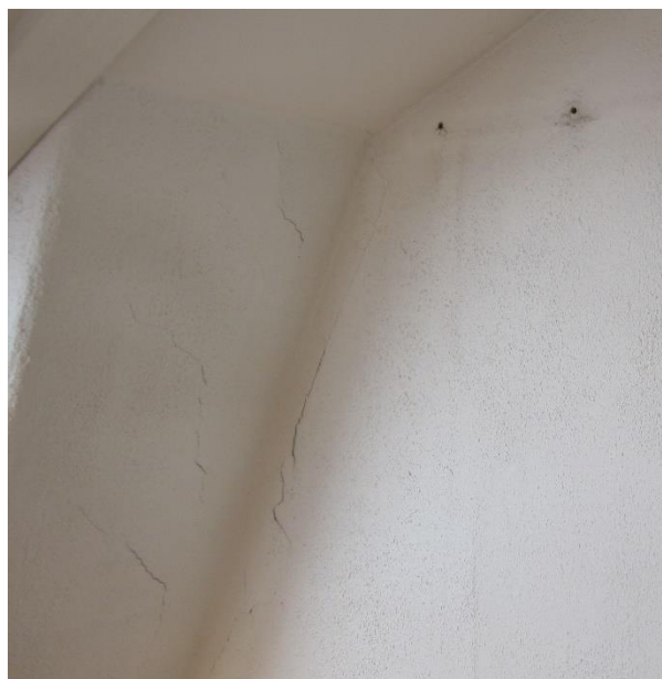
Figur 11 Sprickor i putsen Rum 407
