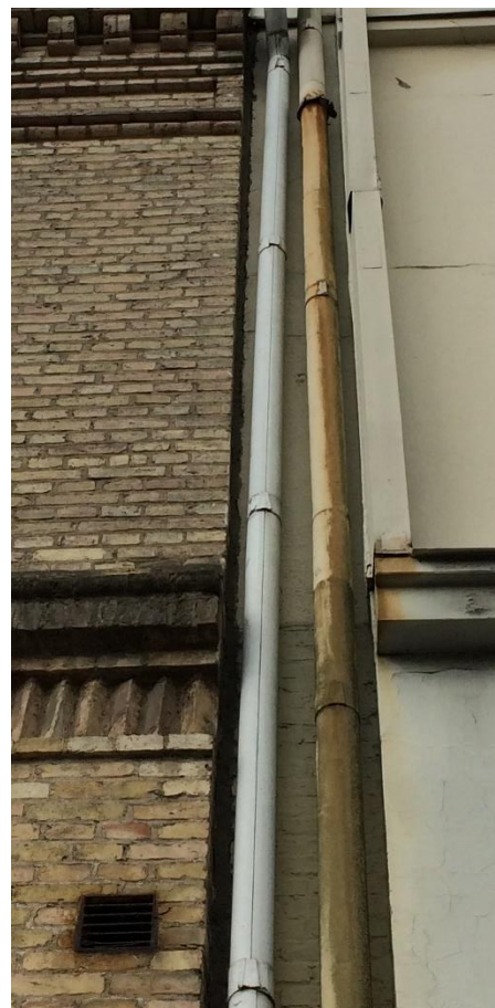
Figur 9 Troligt läckage i skarven mellan fastigheter
