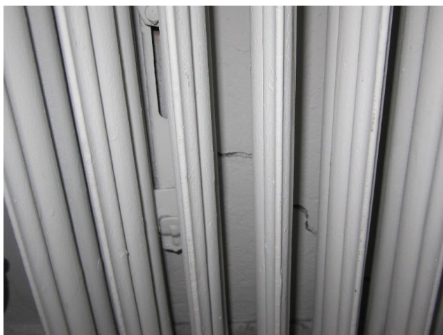
Figur 7 och 8 Spricka våning 2 under fönster närmast port invändigt, respektive utvändigt
