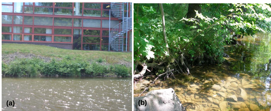
Figur 7 (a) Norra sidan: Erosionsskydd av god kvalitet (b) Södra sidan vid SKF:s parkering: Spår av tidigare erosionsskydd och måttlig pågående erosion.
