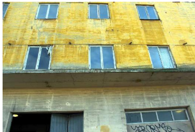
Detalj av fryshuset som är i behov av renovering och underhåll - något som pågår just nu.
