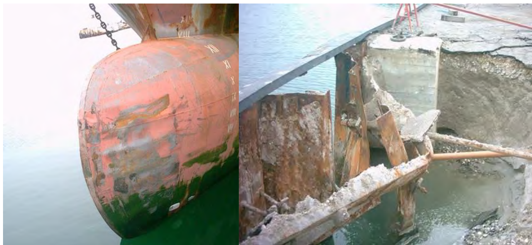
Figur 14. Den vänstra bilden visar en fartygsbulb som är intakt efter att ha penetrerat en spontkaj med sandfyllning. Den högra bilden visar den uppfläta spontkajen
