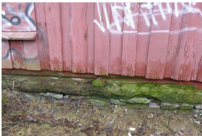
Detalj av den kvarvarande ladugårdslängans timerstomme och panelinklädnad. Stommen är kraftigt rötskadad.
