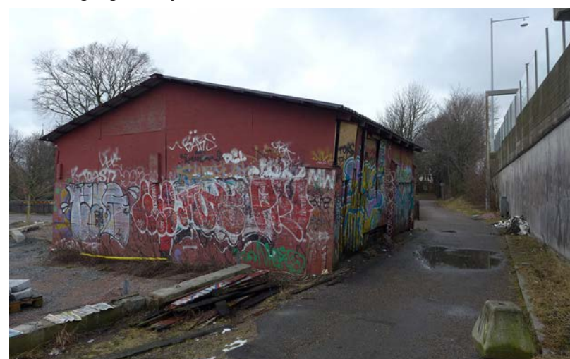
Den kvarvarande delen av den södra ladugårdslängan, idag i mycket dåligt tekniskt skick.
