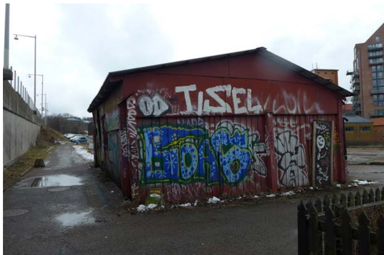
Den kvarvarande delen av den södra ladugårdslängan, gavelfasad mot öst. Byggnaden är idag i dåligt tekniskt skick.
