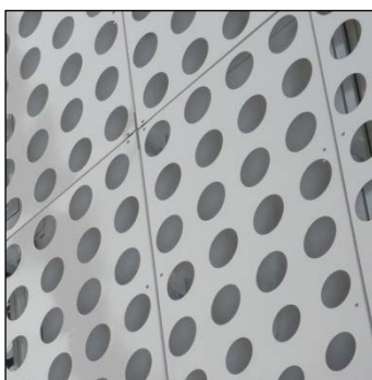
Figur 11. Perforerad fasad med bakomliggande ljudabsorbent.
