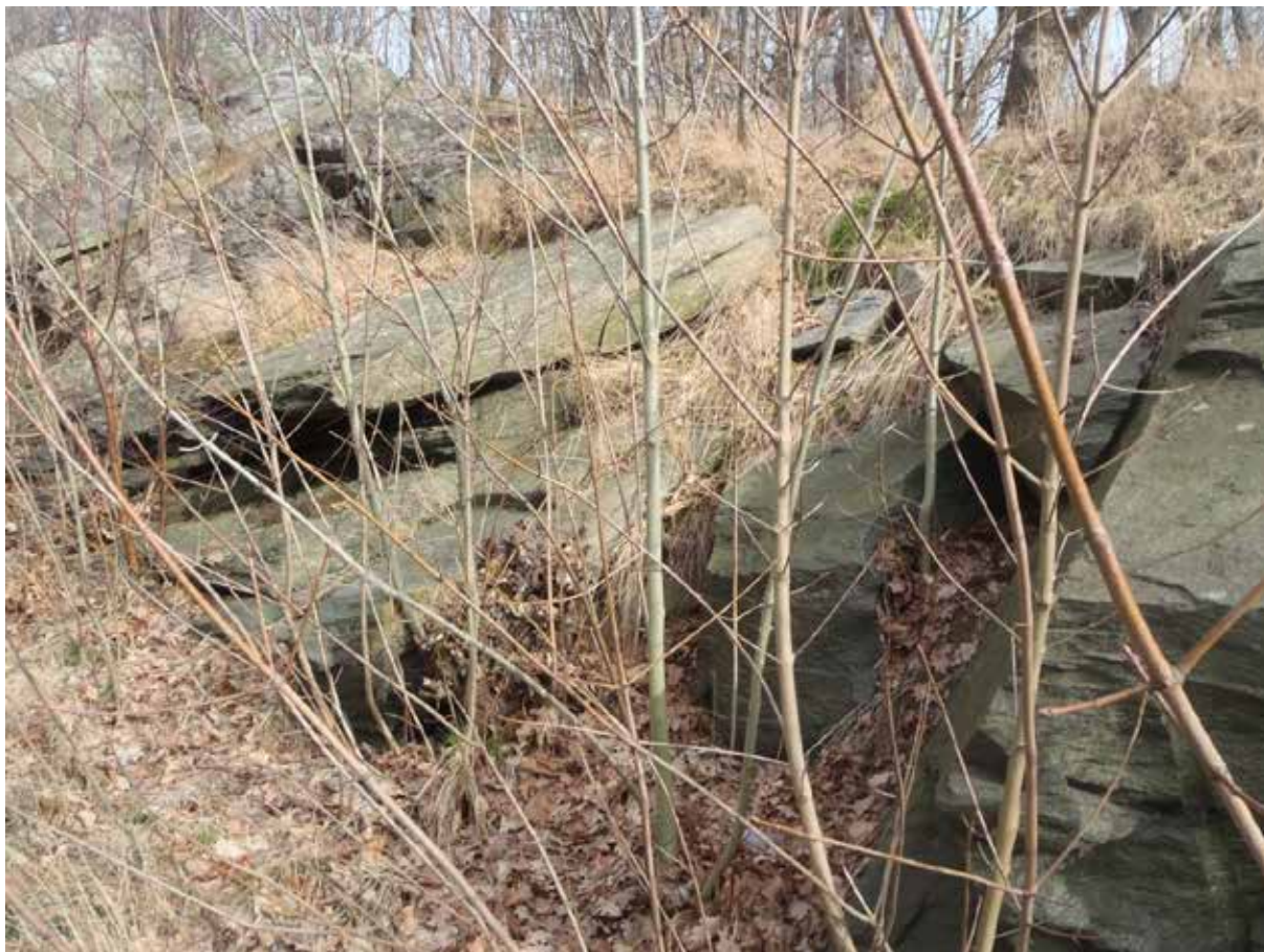
Foto 8. Ökad skivighet och småblockig uppsprickning i den södra delen av bergskärningen längs Ulfsparrégatan. Bild tagen mot nordöst.
