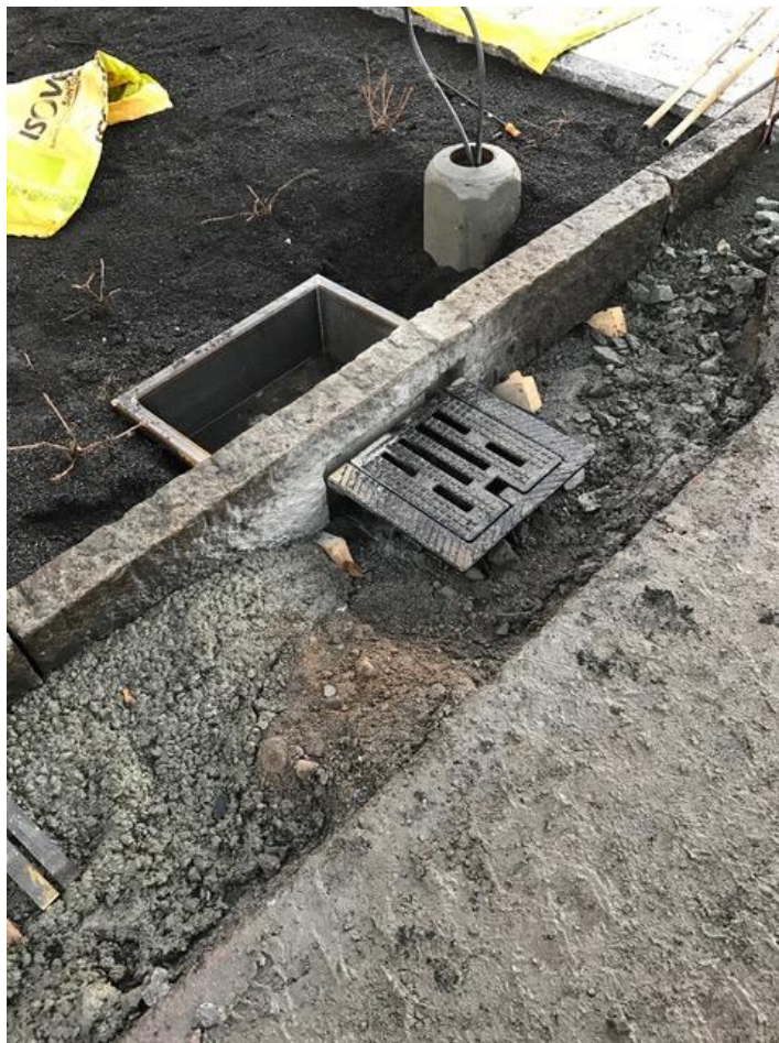
Figur 24. Dagvattenbrunn med sidoutflöde samt efterföljande spridningskar och regnbädd (foto: Pekuma AB)
