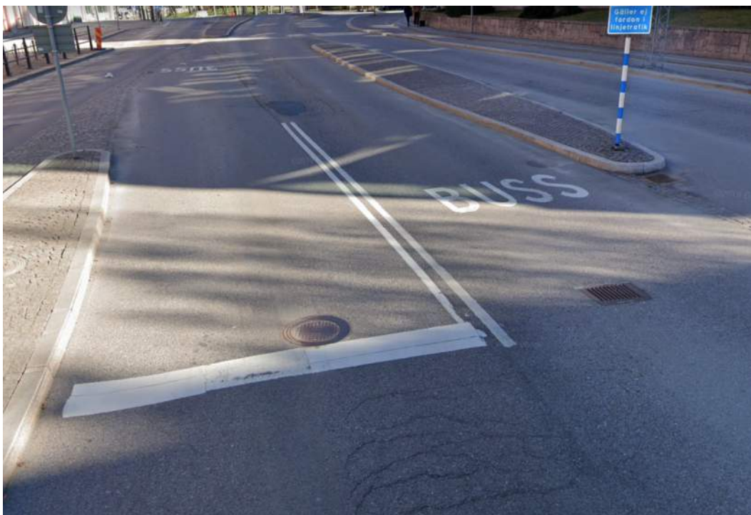
FIGUR 1 EXEMPEL PÅ SKADOR OCH OJÄMNHETER SOM KAN GE HÖGA VIBRATIONSHASTIGHETER I OMGIVNINGEN (EJ FRÅN LINDHOLMSALLÉN)
