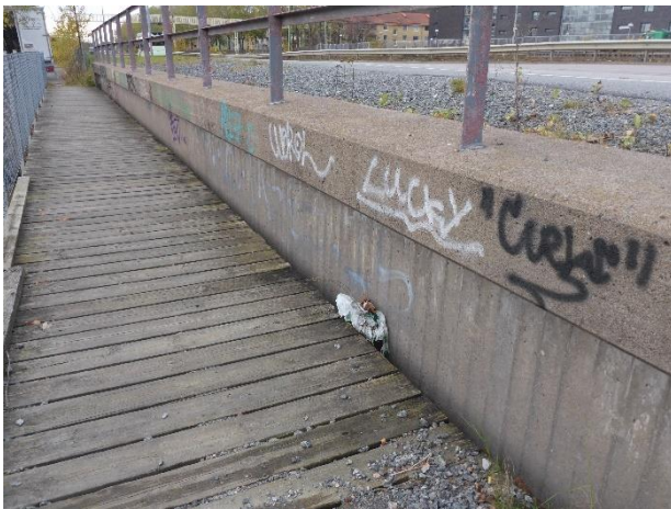
Figur 9: Klotter på utsida kantbalk sydöstra sidan.
