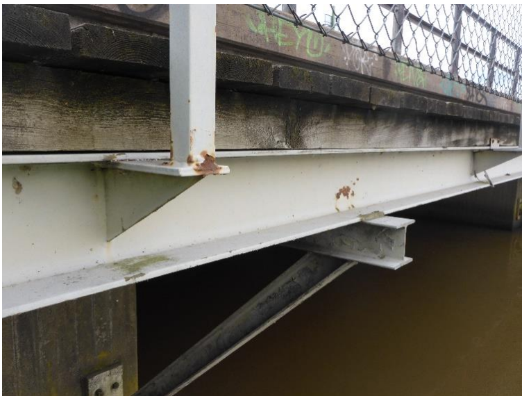
Figur 15: Fläckvis korrosion på konsoler och balkar.
