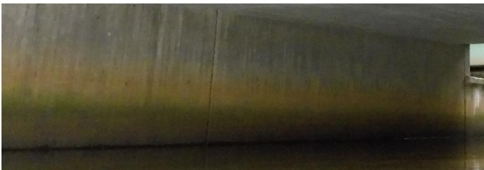
Figur 13: Vittrad betong i skvalpzon på sydvästra benet.
