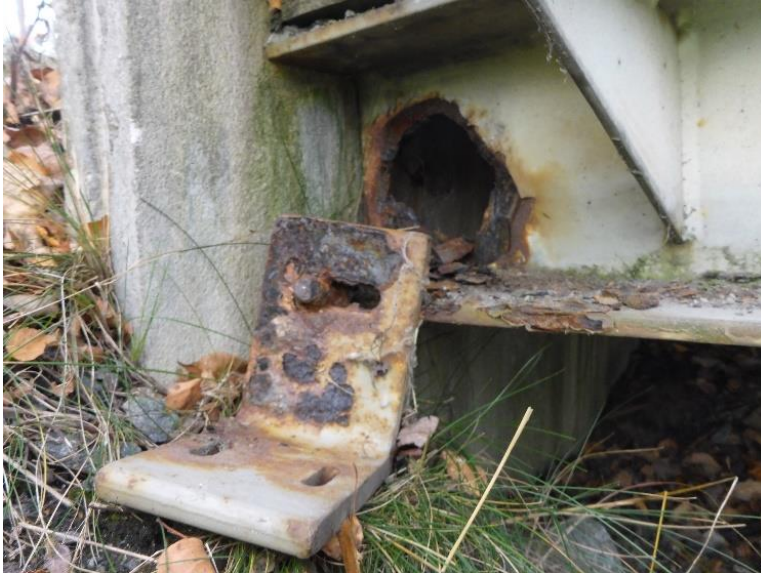
Figur 14: Avkorroderad infästning på sydvästra landfästet. Nordöstra sidan är i liknande skick.
