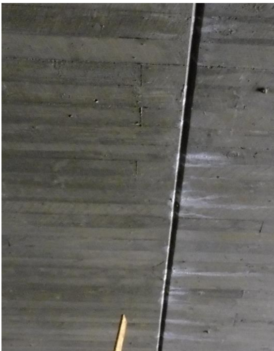
Figur 11 : Kalkutfällning i skarv, underkant platta.
