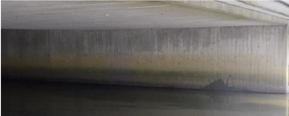
Figur 12: Vittrad betong i skvalpzon på nordöstra benet.
