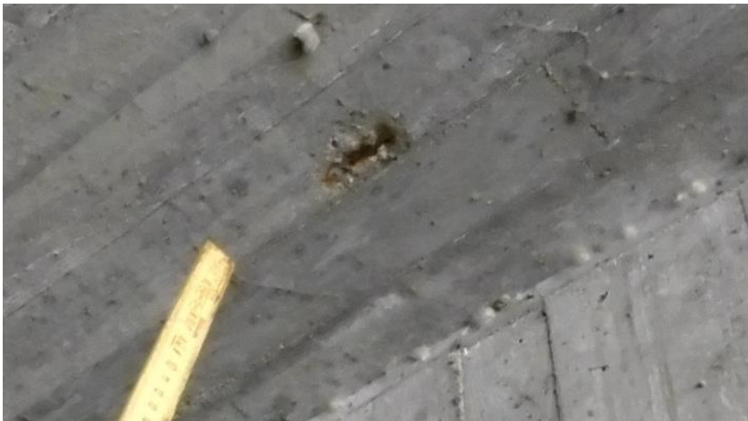
Figur 10 : Synligt armeringsjärn, dåligt täckande betongskikt.
