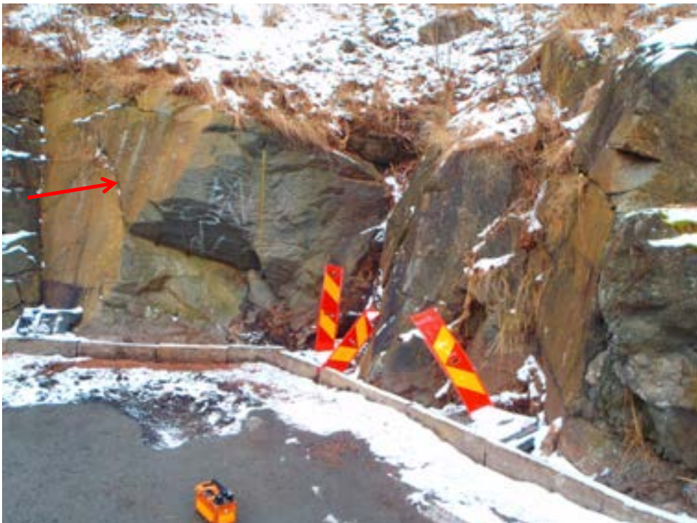
Foto 2. "Fickan" i Volrat Thamsgatans västra sida. Till vänster om sergeanterna sitter ett block som är "säkrat" med två vertikala bultar. En spricka löper medelbrant uppåt slänten, markerat med röd pil. Blocket bedöms hänga ihop med berggrunden till höger, bakom den vänstra sergeanten, och inte utgöra risk för nedfall.
