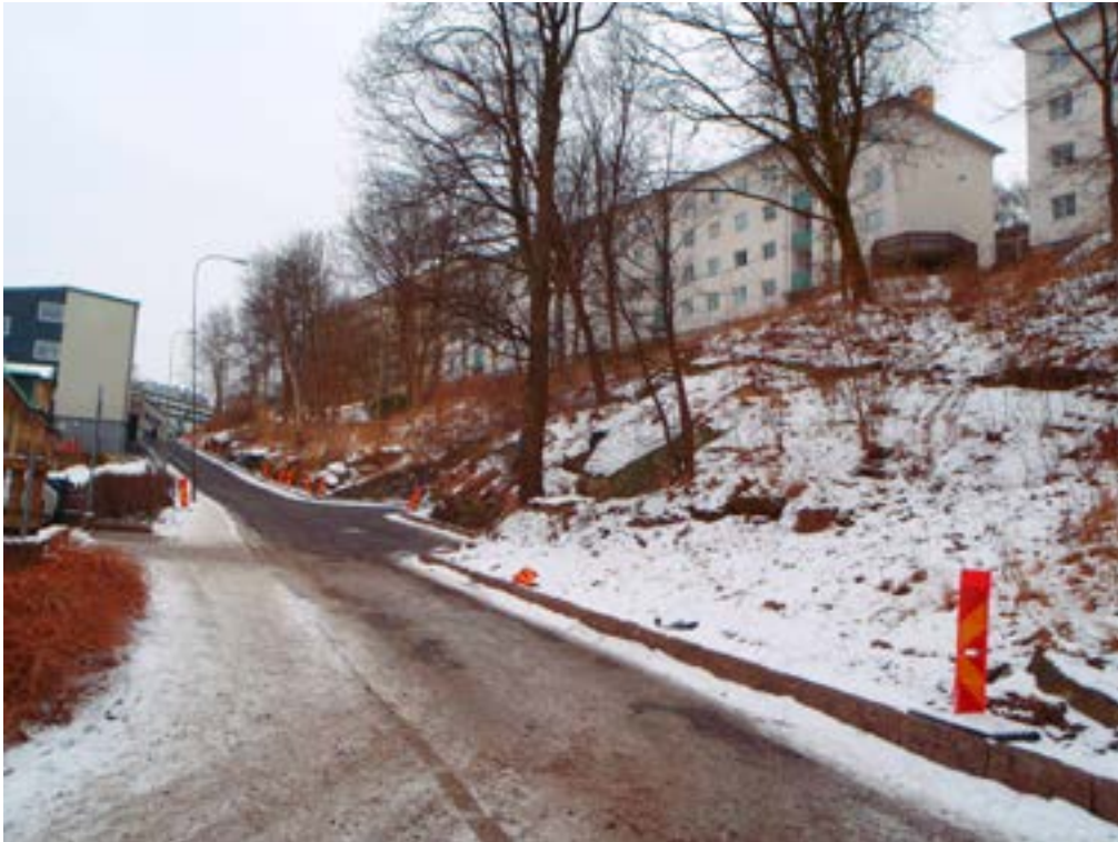
Foto 1. Volrat Thamsgatan sedd från trapporna upp till Viktor Rydbergsgatan. Slänten till höger bedöms idag vara stabil.
