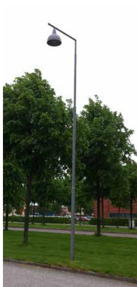
Befintlig belysningsarmatur utmed vägbanan
