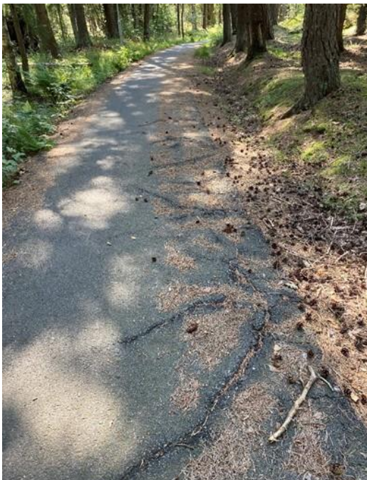
C.3:2 Gång- och cykelbanan genom skogen är i behov av underhåll.
