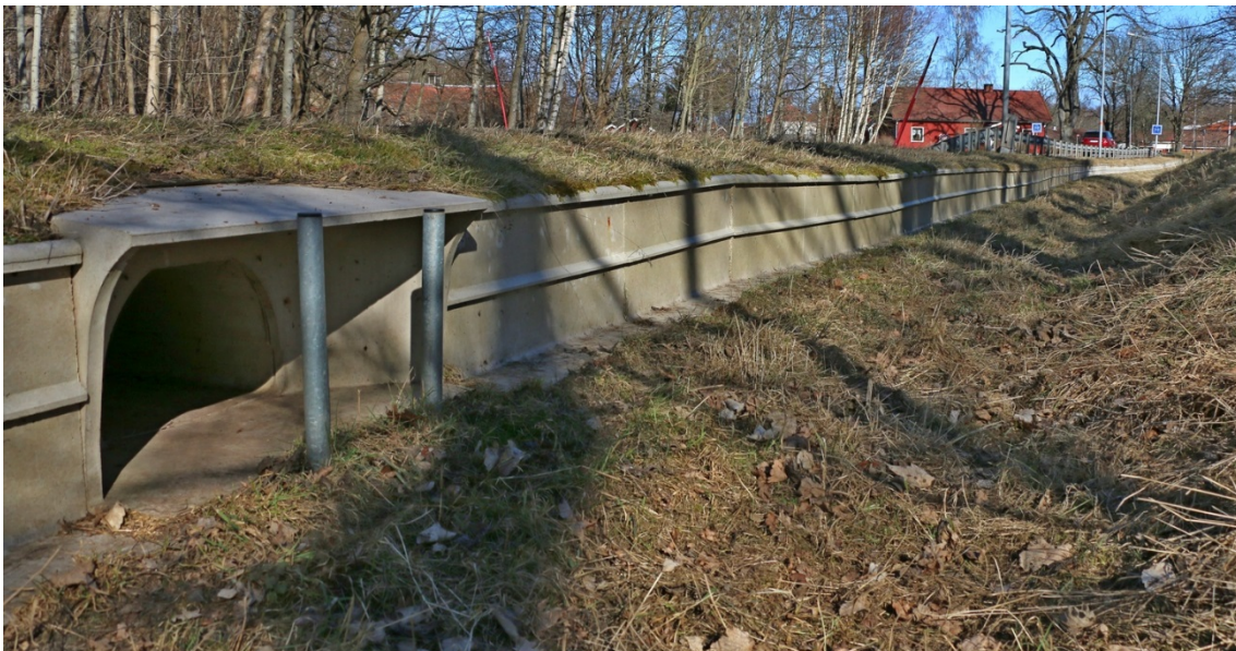
Figur 19 Exempel på faunapassage för grod- och kräldjur under väg.
