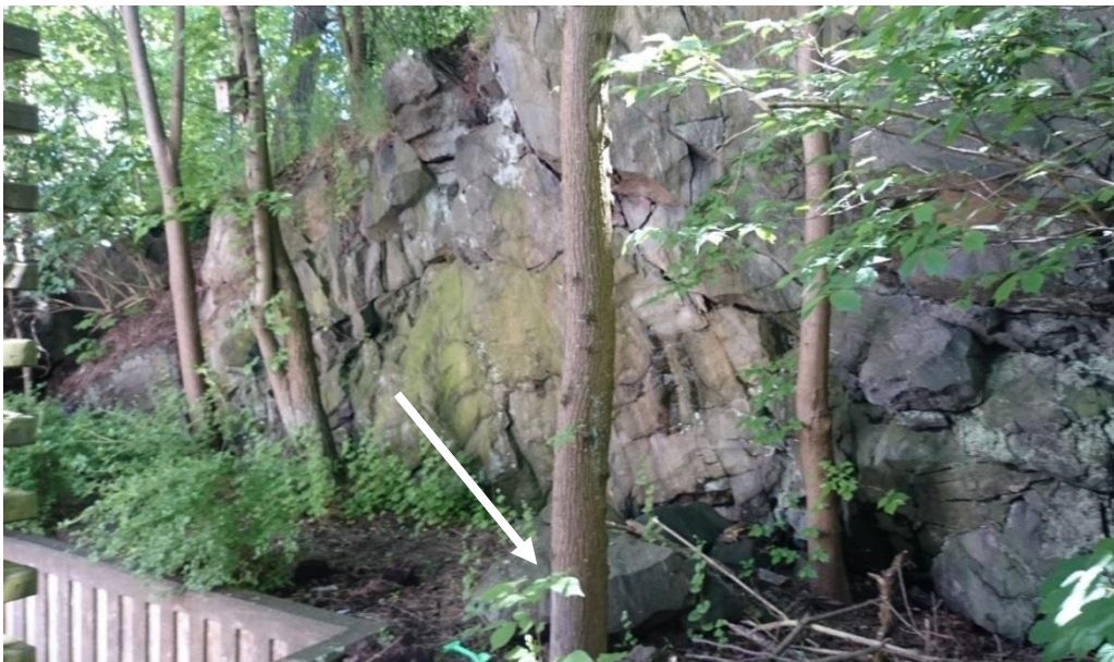
Bild 5. Södra bergskärningen från innergården. Block har fallit ut, se pilmarkering.
