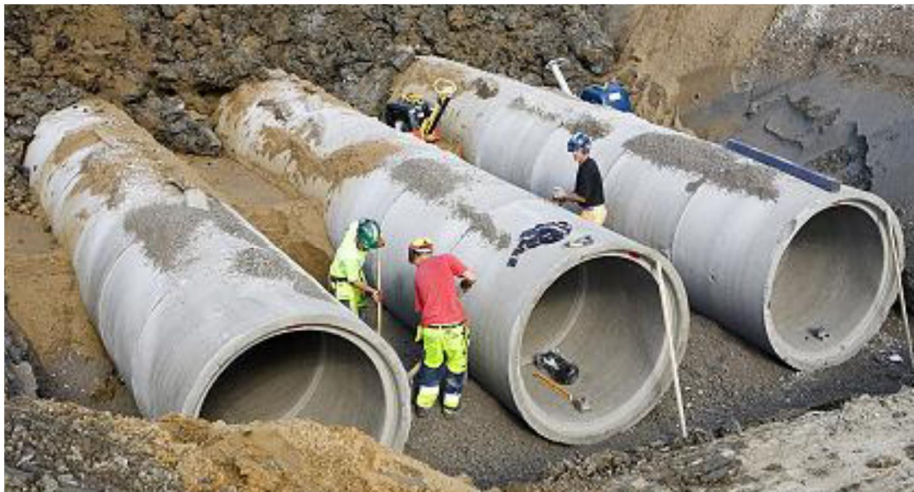
Figur 9. Dagvattenmagasin av betongrör.
