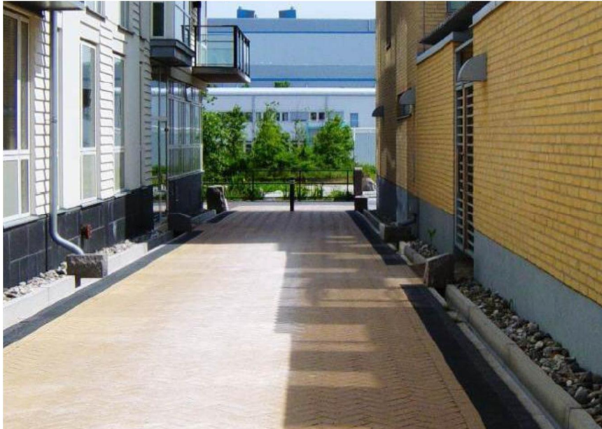
Figur 3. Stuprören ansluter till rännor för avledning av takvatten.
