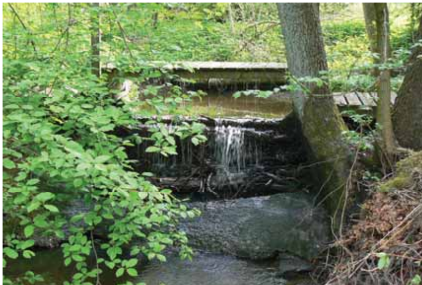
Vandringshinder för fisk i form av betongdämme ca 400 m uppströms Utbyvägen.
