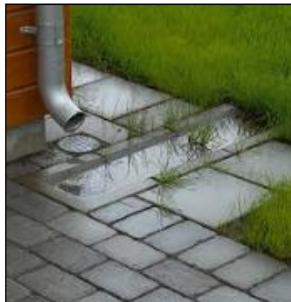
Figur 18 Ränn dal som leder takvatten till översilning och ytlig transport till rainingarden.
