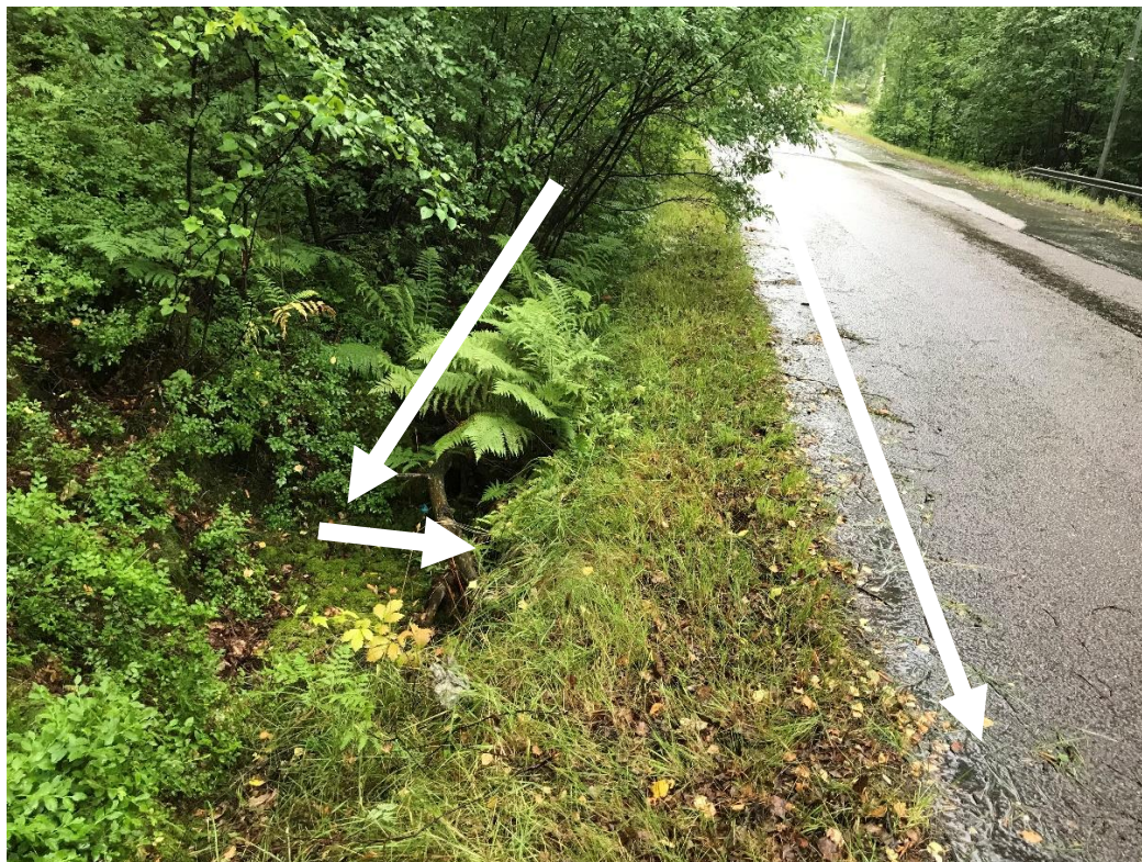
Figur 6. Vägens avrinning sker utmed vägkanten längre österut istället för till diket. Diket som avvattnar planområdet kulverteras under vägen enligt pilmarkering i figuren
