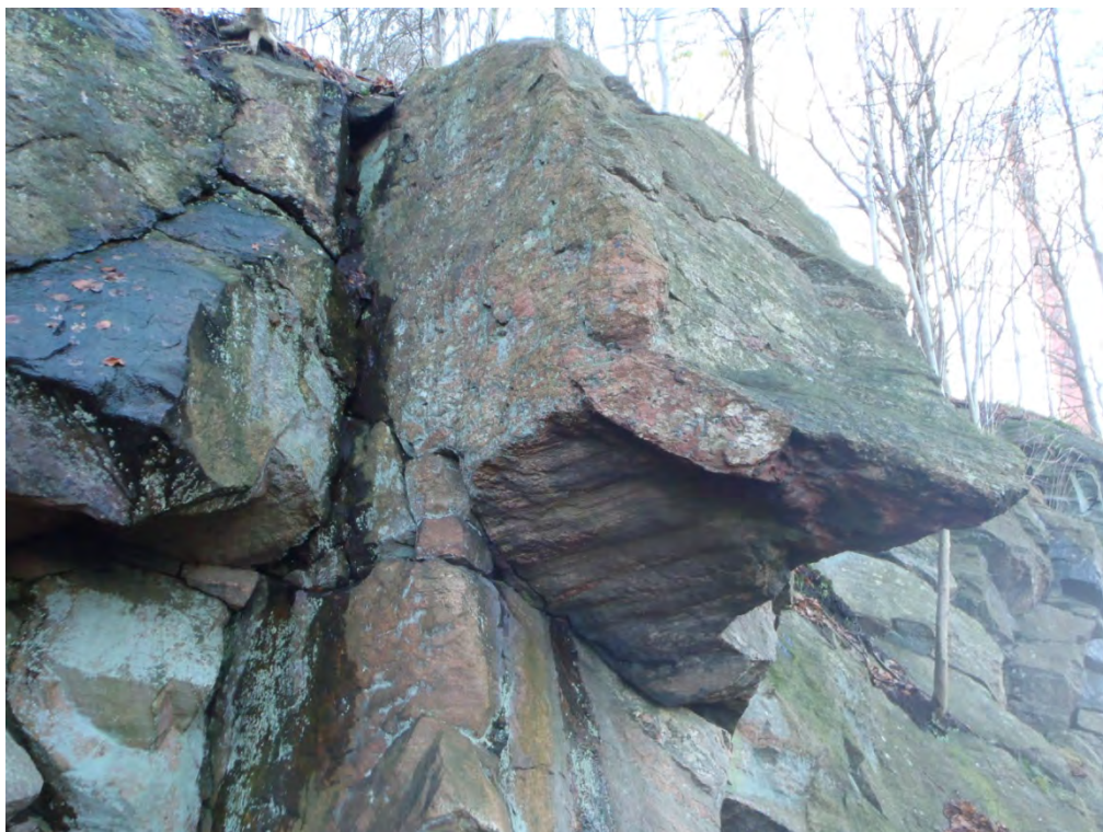
Foto 11. Instabila block mellan de båda bergrummens påslag, område A. Blockens kantstorlek ca 2 m. Ovanför blocken vidtar en blockslänt med lösliggande, uppallade block.
