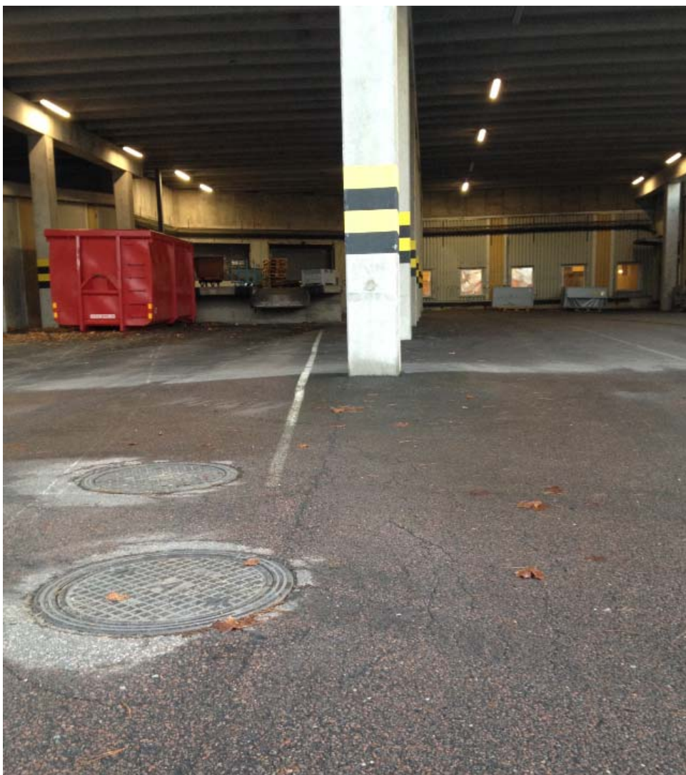
Figur 6 Pålade pelare vid kyl- och distributionslagret där sättningar utvecklats.
