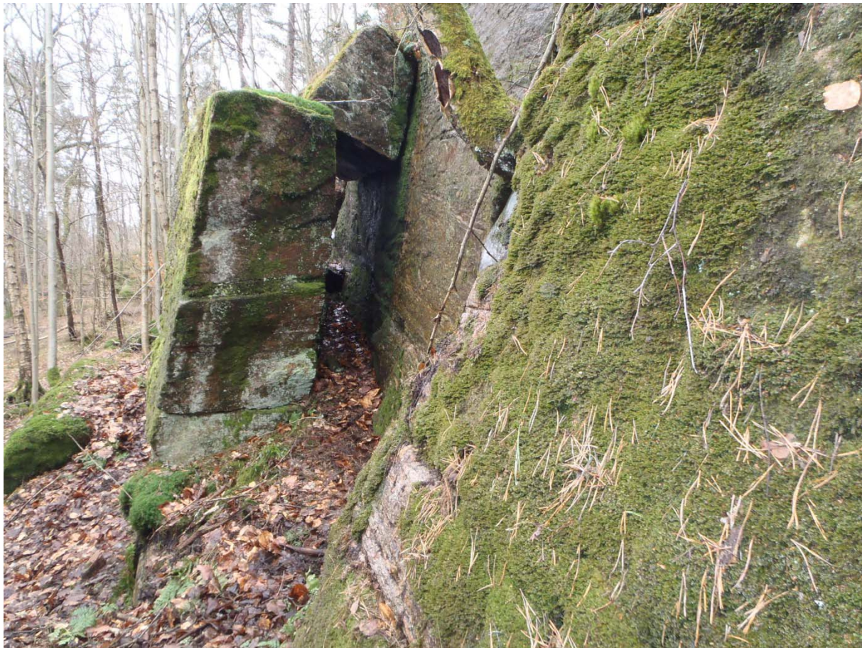
Foto 11. Vid punkt 4 i Bilaga 2 bildas släntsidan av branta sprickor ur sprickgrupp 2. Dessa bildar brantstående skivor som idag bedöms vara stabila.
