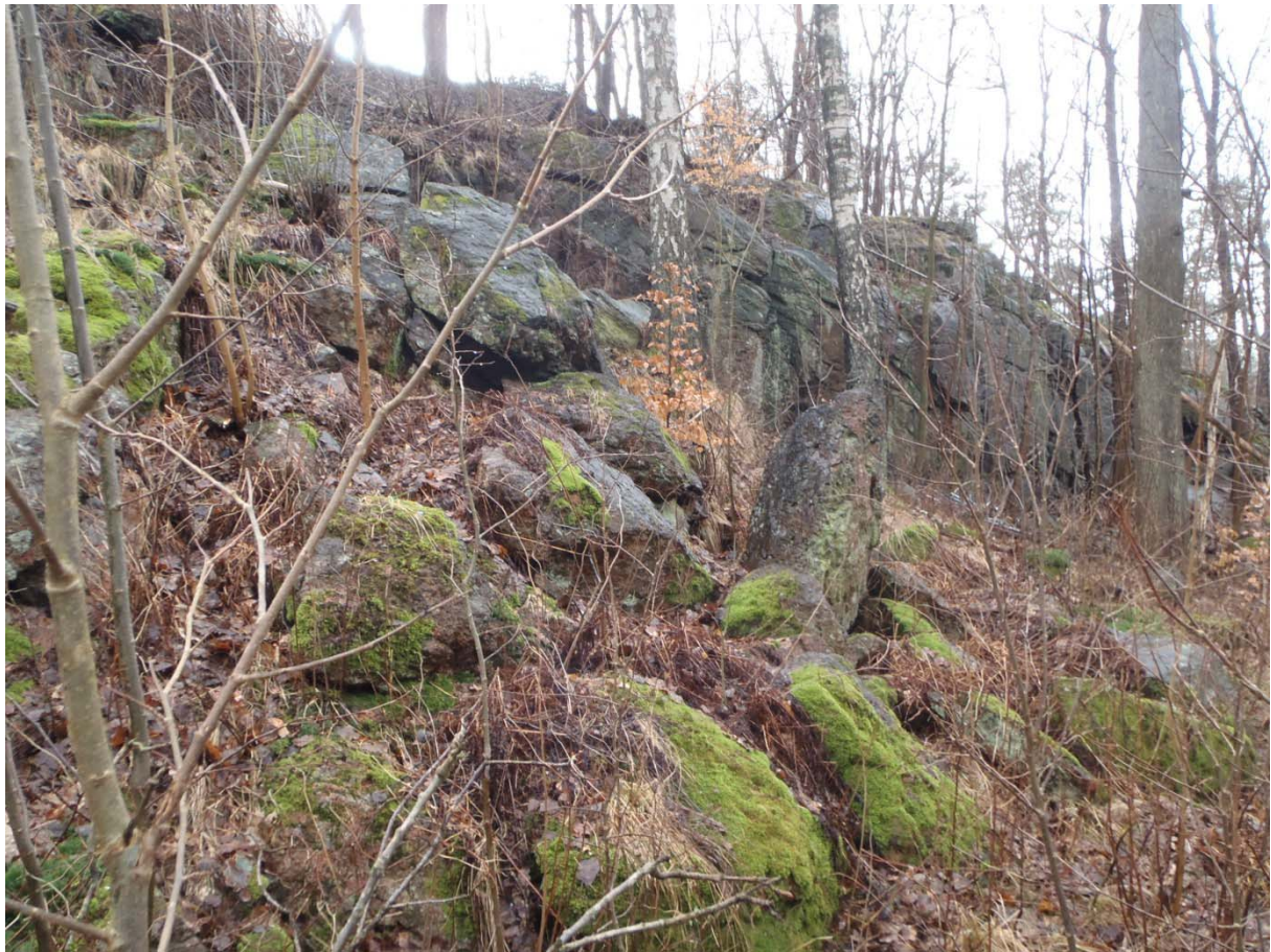
Foto 6. Blockslänt väster om Studiegången, punkt 2 i Bilaga 2. Blockslänten bedöms idag vara stabil men enstaka potentiellt lösa block förekommer i borte delen av slänten.
