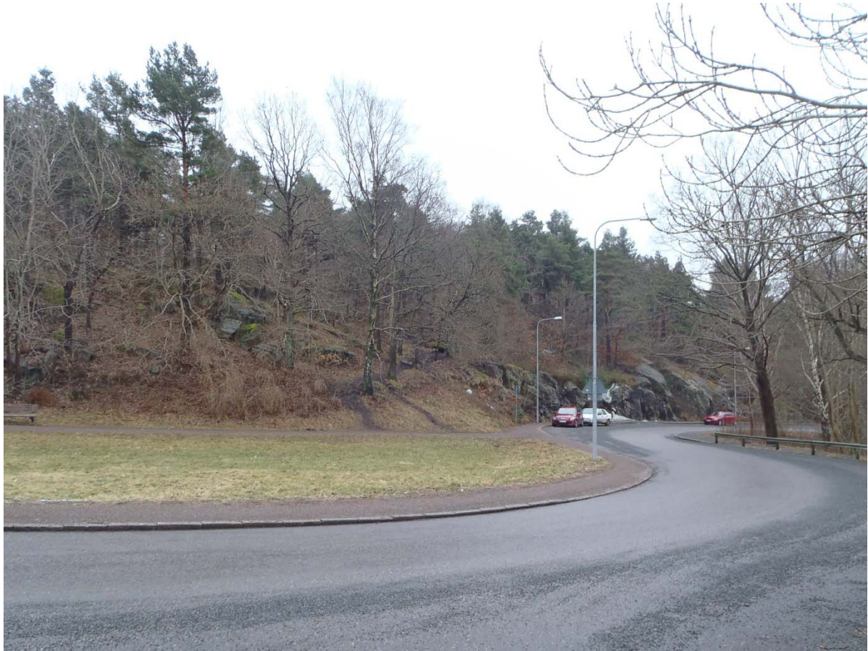
Foto 8. Naturlig slänt och skärning vid Sanatoriegatan, vid undersökningsområdets västra gräns. Slänter och skärningar bedöms vara stabila. Skärningen vid bilarna är bultad men bultarna är märkligt nog satta i block som ej behöver stabiliseras.
