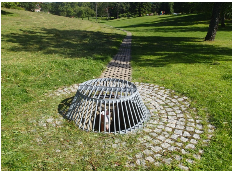
Foto 2. Stendike med magasin som leder till en stor kupolbrunn i dalen vid Kålltorps äldreboende
