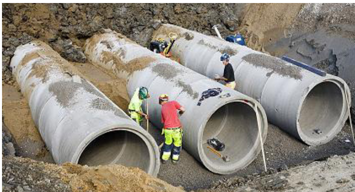
Bild 10. Dagvattenmagasin av betongrör. Källa: www.steriks.se
