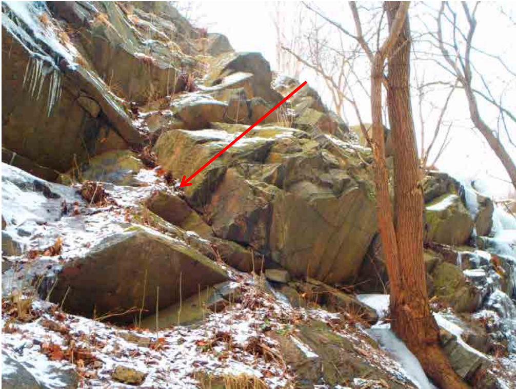
Foto 5. Detalj av Foto 4: sprickor som lutar medelbrant ut ur skärningen (röd pil) ger potentiellt instabila block. Bergrensning och eventuell bultning bör utföras. Bild tagen mot nordväst.
