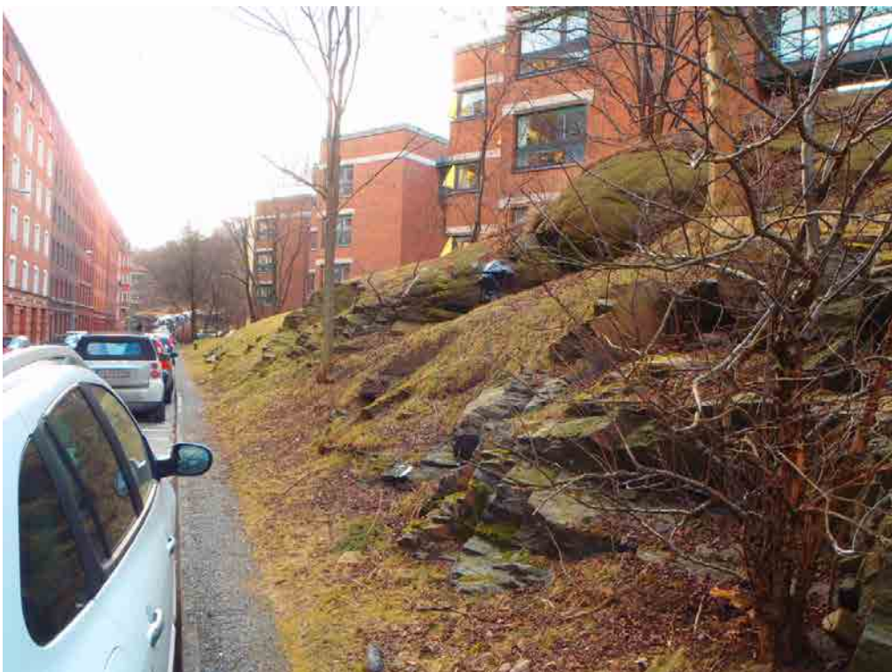
Foto 2. Skärning längs Lundgrensgatans västra sida. Skärningen och den naturliga slänten bedöms idag vara stabila. Bilden tagen mot syd.
