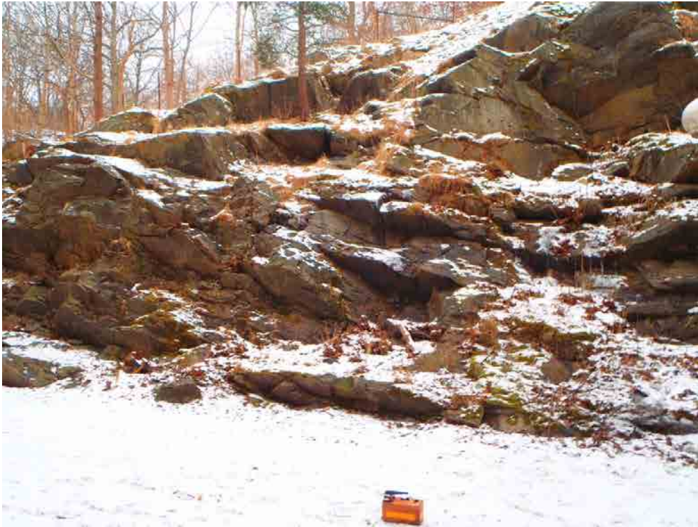
Foto 3. Södra delen av bergskärningen bakom Språkskrapan. Träd och löst bergmaterial finns i skärningen. Berg- och vegetationsrensning bör utföras. Bild tagen mot sydväst.
