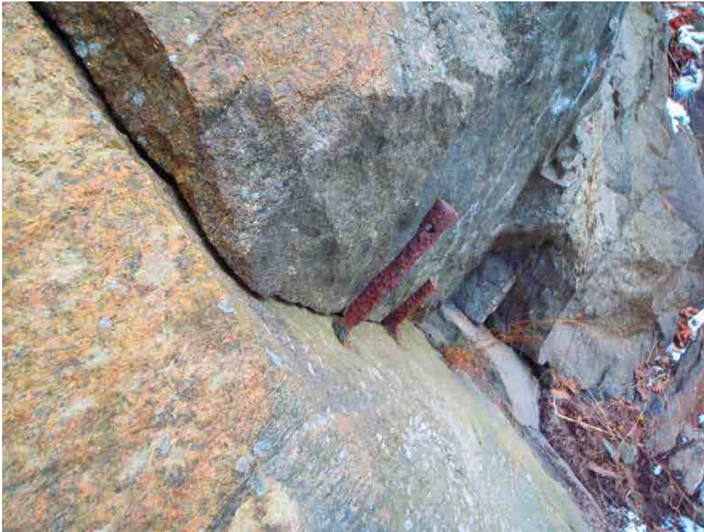
Foto 3. Närbild av de genomrostade bultarna framför blocket i Foto 2. Bultarna saknar funktion; det är ett ca 10 mm stort mellanrum mellan bultarna och själva blocket.
