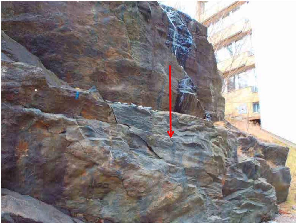
Foto 5. I bergskärningens norra hörn noterades potentiellt instabila block (röd pil). Bergrensning bör utföras i det norra partiet, eventuellt även bultning.
