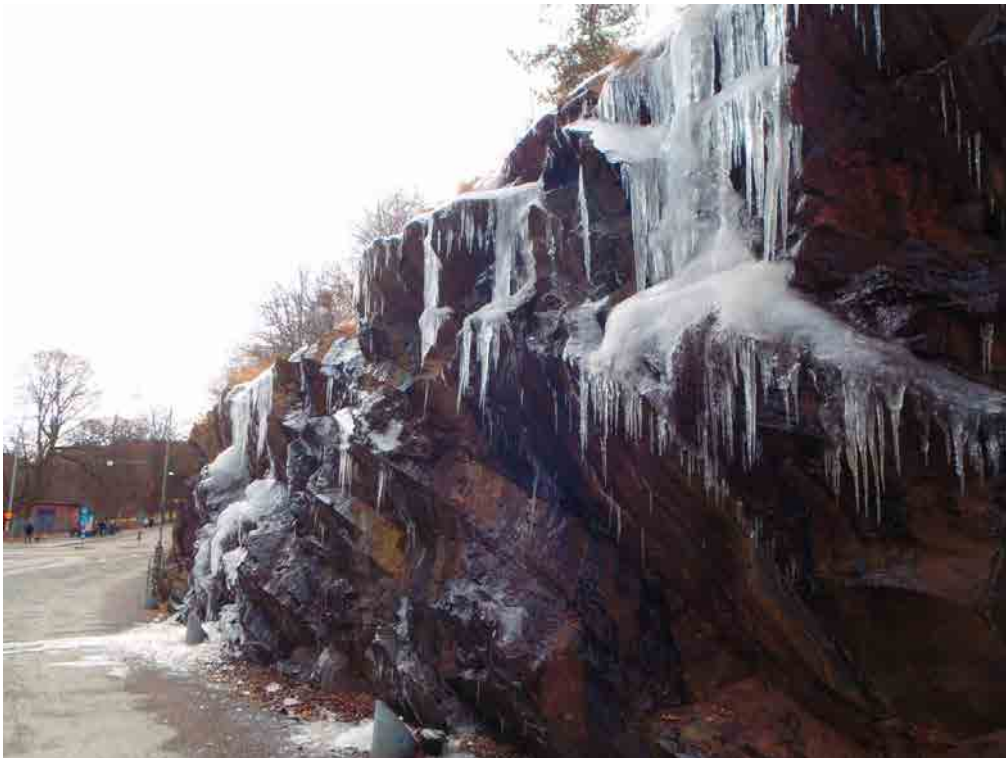
Foto 4. I bergskärningens norra ände strömmar stora mängder vatten ut och bildar istappar och svallis.
