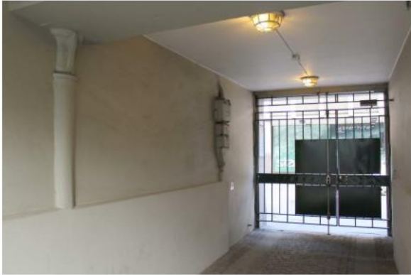
Portgång etablerad 1907. Vid väggen skymtar en av två gjutjärnspelare i original som användes för avväxling vid ombyggnaden.
