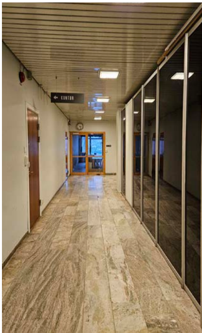
Sentida mellanväggar som förtar entréhallens öppna karaktär.
