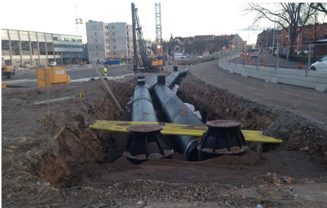
Figur 19: Exempel på ett nyanlagt rörmagasin i Norrköping (SMHI, 2016).
