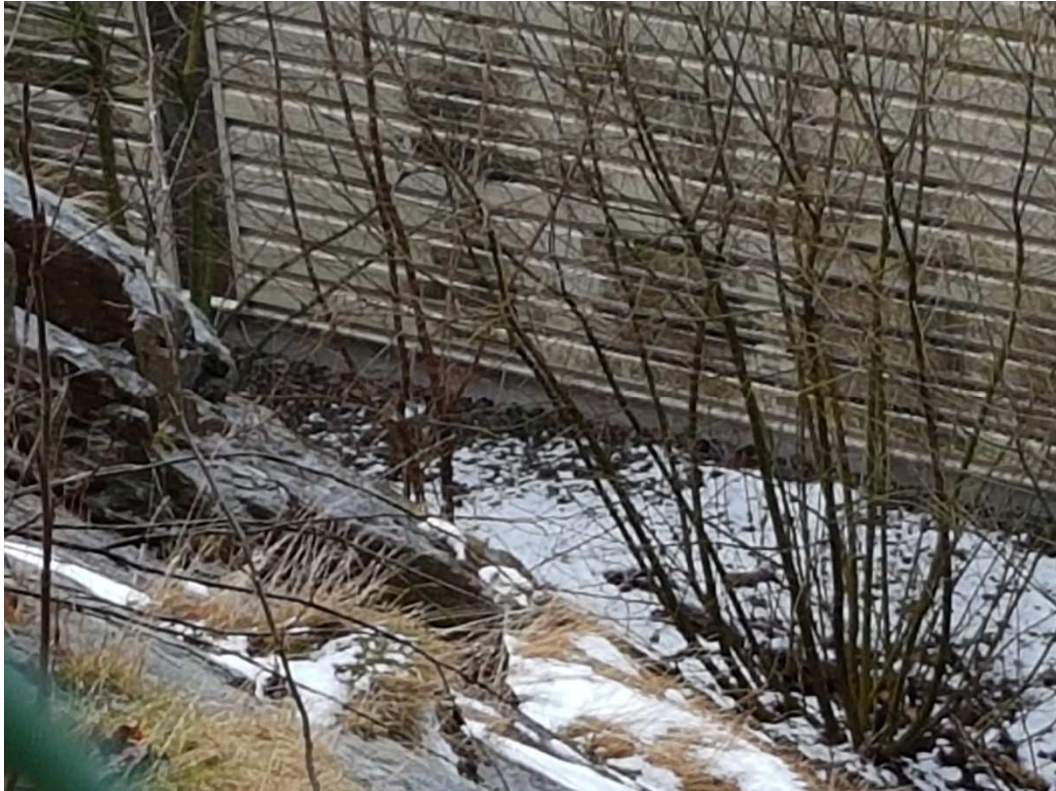
Figur 9 Bergskärning i område 3, där bergrensning och kompletterande bult behöver utföras.
