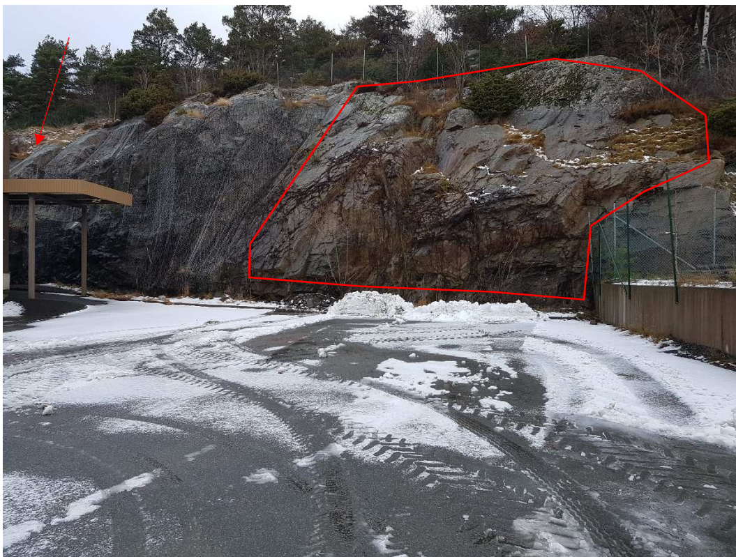
Figur 6 Bild på bergskärning i anslutning till befintlig industribyggnad, där bergrensning och eventuell kompletterande bultning behöver utföras. Även område markerat med pil behöver bergrensas och kompletteras med bult/bergnät.
