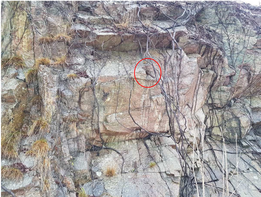
Figur 7 Bild på bergskärning i anslutning till befintlig industribyggnad, där bultänden sticker ut, se röd markering. Kontroll av ingjutningen vid befintliga bultar behöver utföras.
