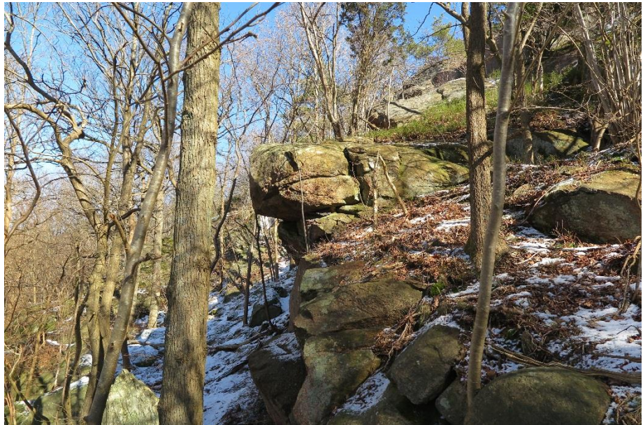
Figur 12. Slänten sett ovanifrån. Pågående rotsprängning orsakad av vegetation ovanför släntrönn.
