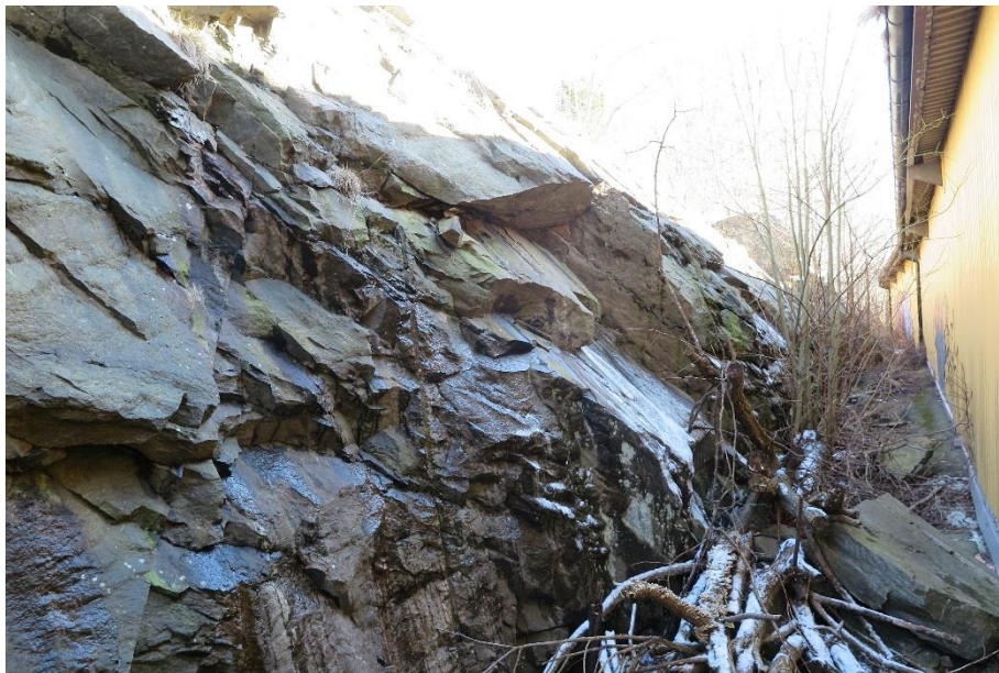
Figur 8. Berget i slänten är skivigt och blockutfall har skett längs sprickytorna.
