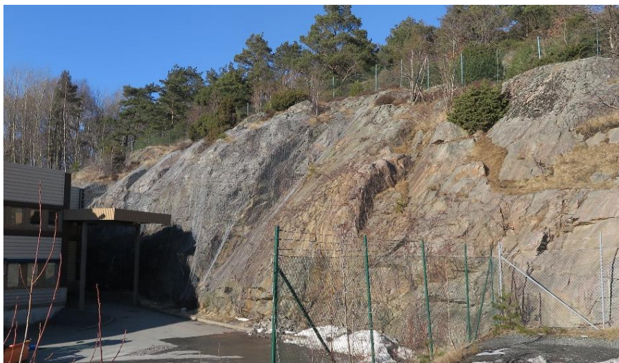
Figur 17. Bergslänten med befintligt nät till vänster i bild.
