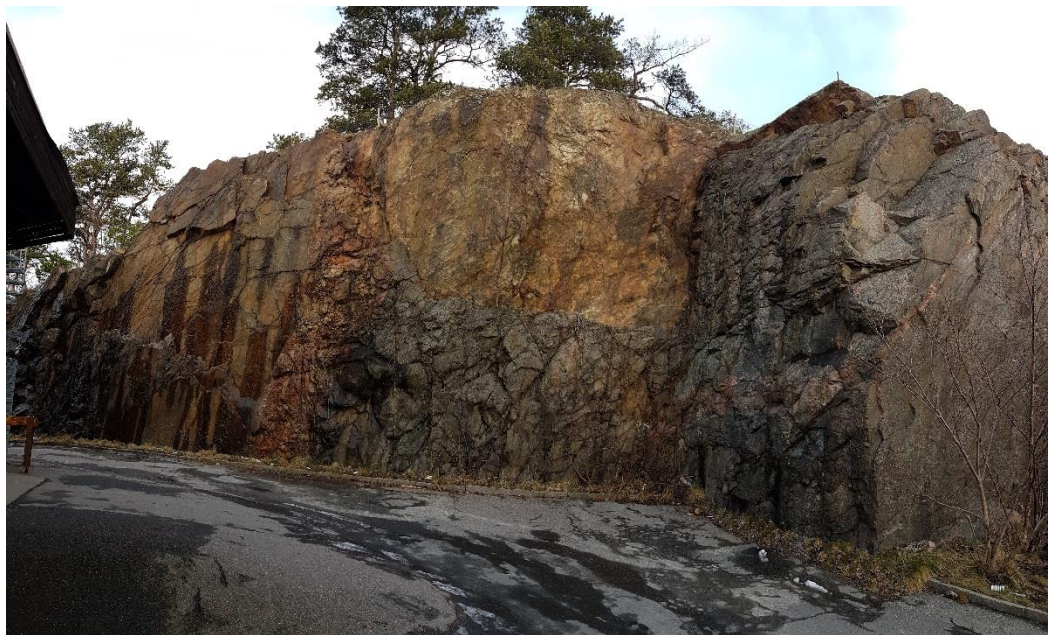
Figur 6. Del av bergslänt som behöver åtgärdas.
