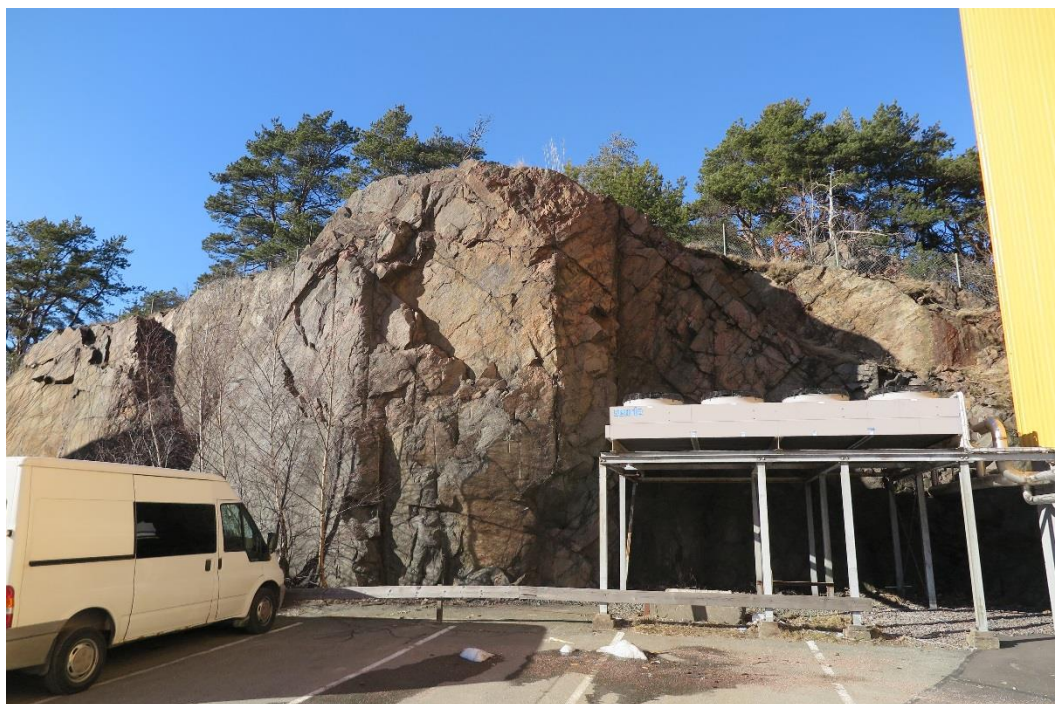
Figur 7. Del av bergslänt som behöver åtgärdas.
