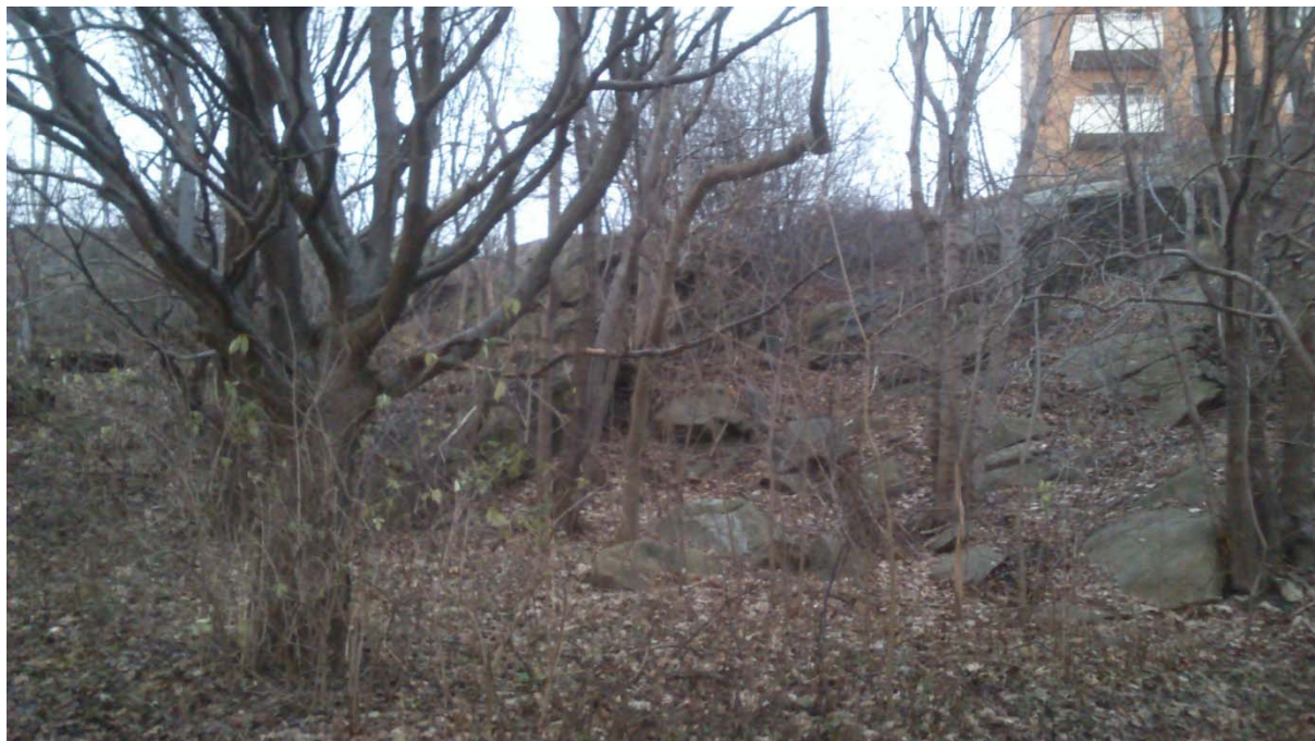
Foto 3. Delområde 3, norra delen. Bilden är tagen mot öster. I jordslänten noteras ett flertal lösblock. Berggrunden är delvis uppsprucken. Bergslänten bedöms dock vara stabil idag.
