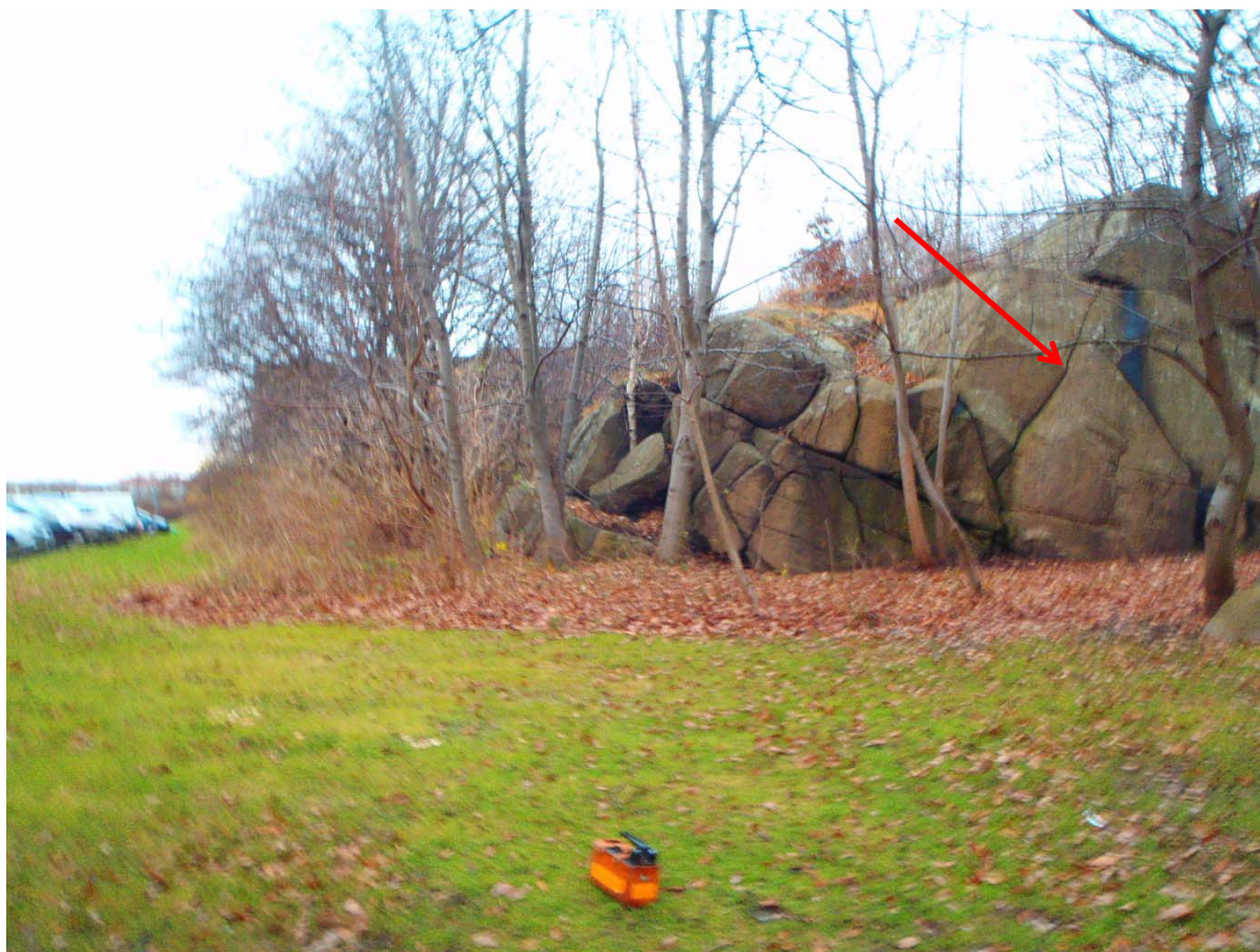
Foto 2. Delområde 2, bergslänten längs Ärlegatan sedd från söder. Bilden är tagen mot norr. Sprickor i sprickgrupp 1 bildar den stabila naturliga slänten. Pilen pekar på en sådan spricka. Vid bergschakt anpassas släntlutningar företrädesvis till dessa sprickplan.
