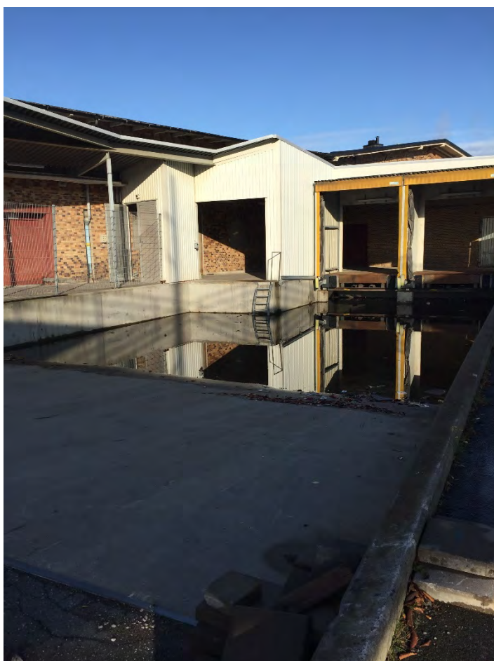
Figur 10. Bilden visar en lågpunkt vid en lastkaj i den östra delen av utredningsområdet som är fylld med regnvatten.
