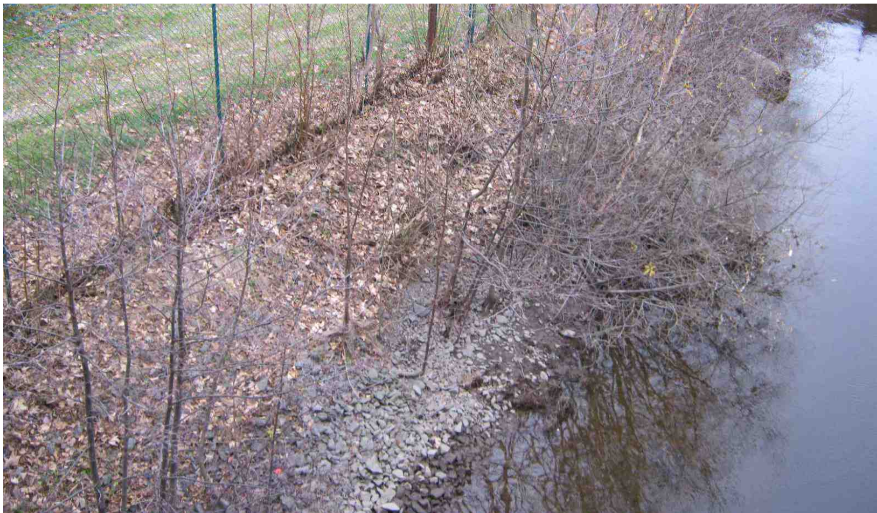
Figur B.1.14 Fotografi tagen från Stallmästarebron östlig riktning över erosionsskydd vid Sävåns norra sida (Delområde D).
