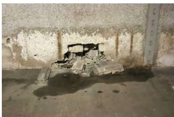
Skada med synlig betongsten.
