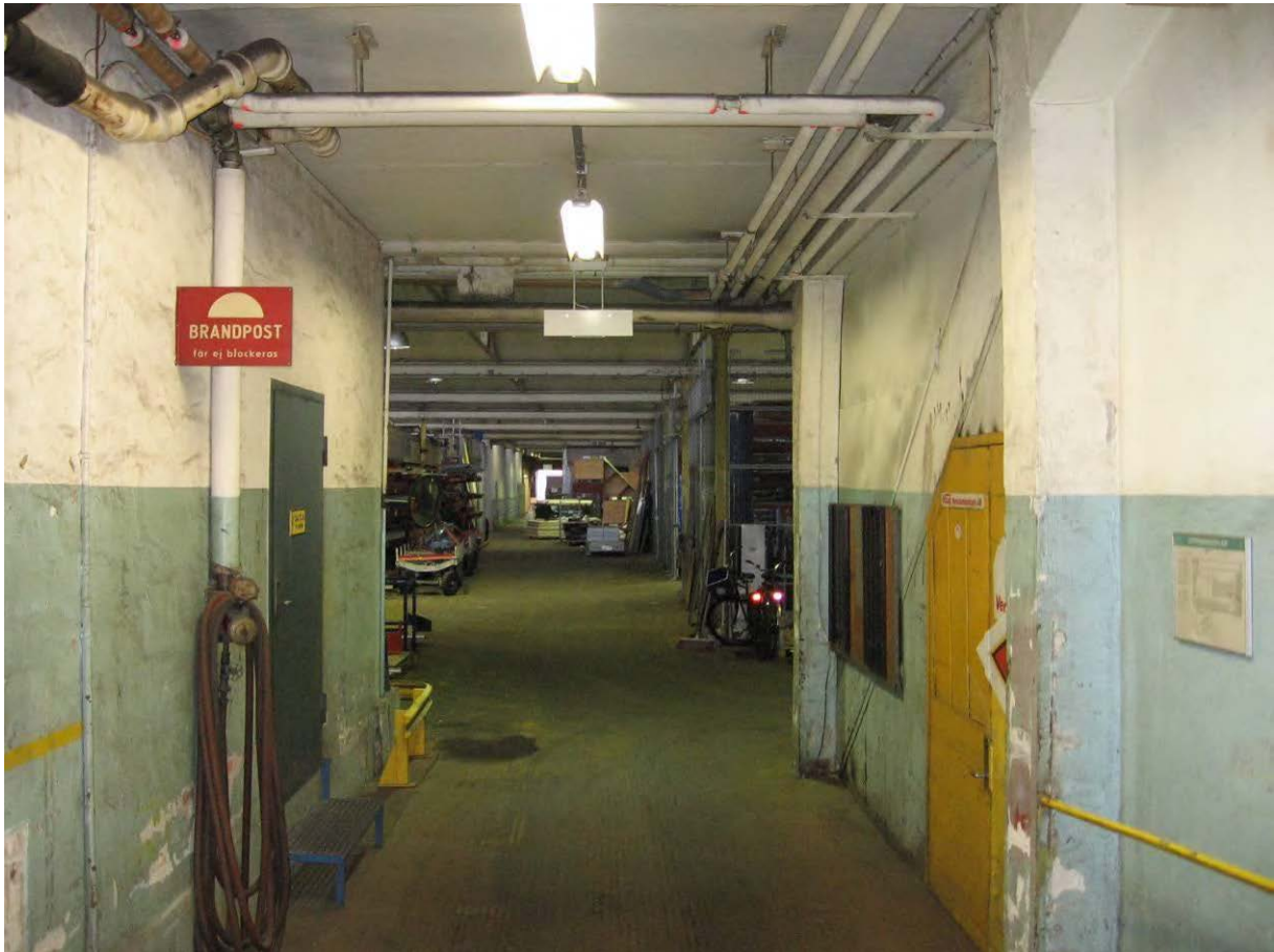
Maskinsalen sedd från norr. Dörr in till transformatoranläggning till vänster i bild.
