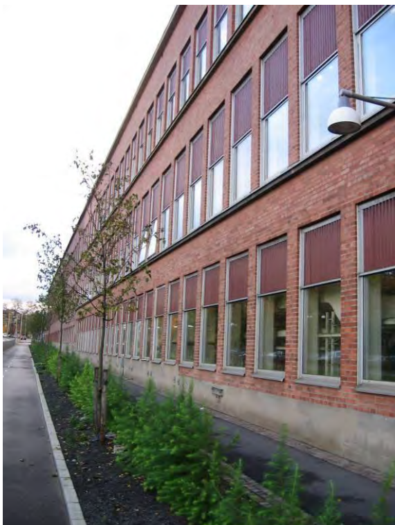
Utbytta delvis igensatta fönster.
