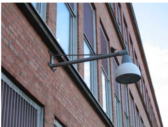
Befintlig väggarmatur, C-fabriken.
