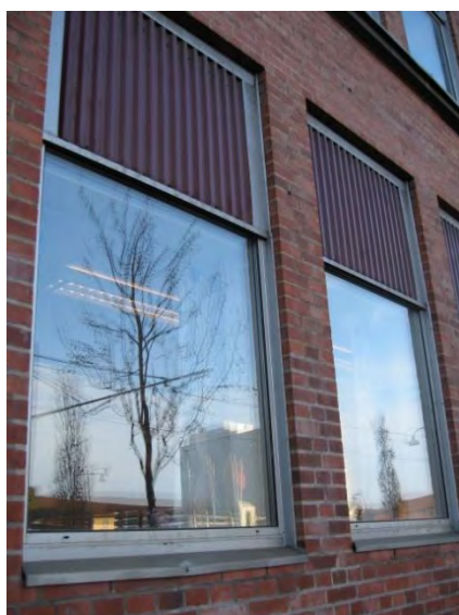
Fönsterbyte som kraftigt förvanskat den äldre C-fabrikens karaktär.
