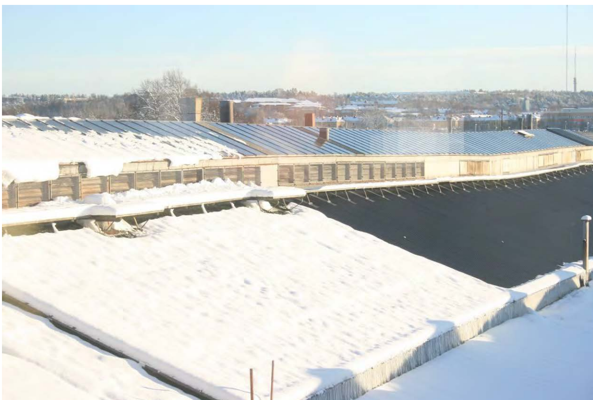
Tak över hårdbyggnad med lamellförsedda fönsteröppningar. Den böljande taklinjen påvisar sättning i bakre delen av byggnaden.
