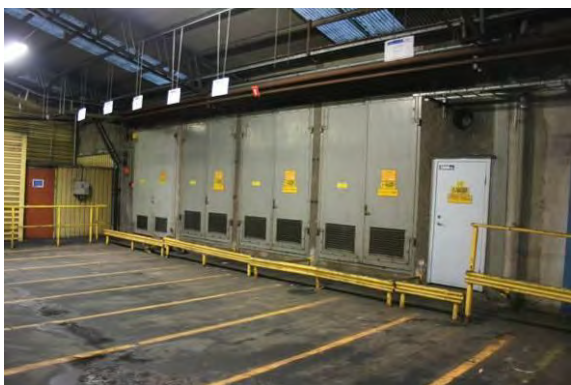
Transformatorrum vid östra fasaden byggt 1941.
