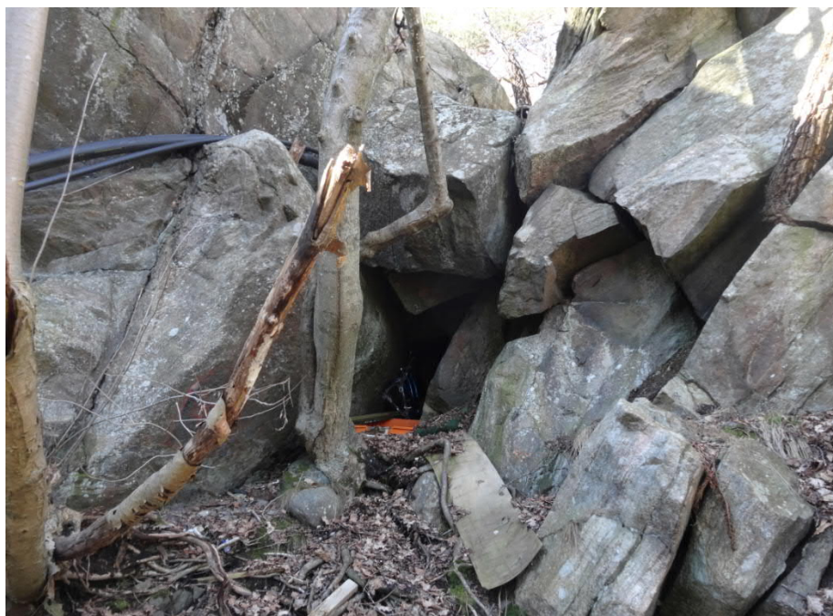
Figur 5 tagen stället längst i norr där en sprickzon går och mycket stora lösa block har skapats. Sannolikt påverkar vattnet som vintertid har frusit och skapat frostsprickor. Man ser också att berget innehåller en del gångbergarter – pegmatit.
