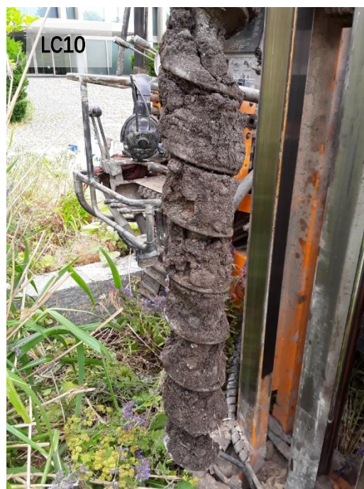
Figur 11. Exempel på sandiga, grusiga och steniga fyllnadsmassor med inslag av rivningsmaterial.
