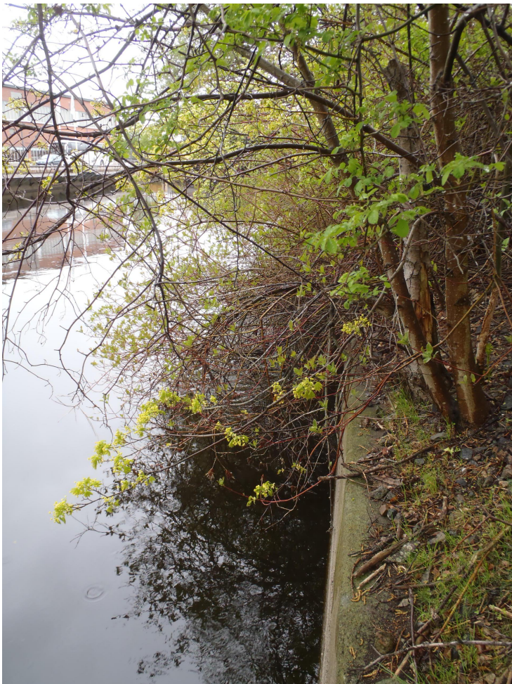
Befintlig stödmur vid ån. Vegetationen har etablerat sig i marken ovanför stödmuren och hänger nu till stora delar ut över stödmuren och över vattnet.
