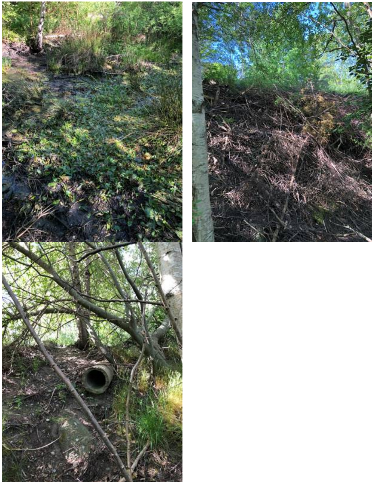
Figur 11. Damm 3 (överst till vänster), dagvattenrör som mynnar vid dammen (nederst till vänster), dumpat trädgårdsavfall i slänten ner mot dammen (överst till höger).
