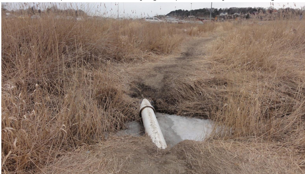
Figur 7. Befintlig spillvattenledning i skyddsror där den korsar bäcken genom planområdet.
