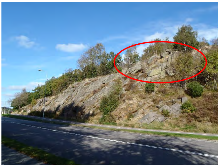
Figur 4.1. Den södra delen av den östra slänten med instabila block markerade.
