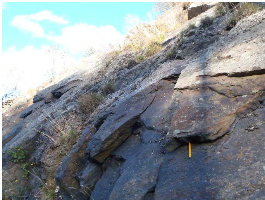
Figur 4.4. Åtgärd nr 2 med pennan instucken under instabil skiva.
