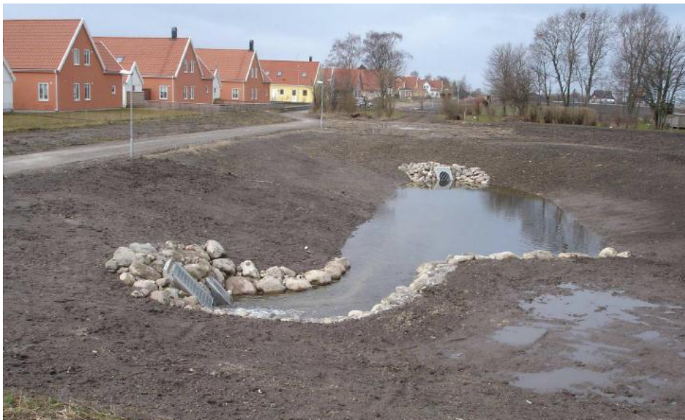
Bild 12. Fördröjningsdamm. Källa: www.vasyd.se .
